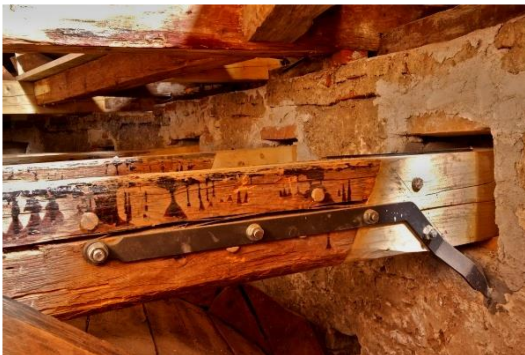
Obrázek 7 - fotografie opraveného stropního trámu v místě trámové kapsy se specifickým kotvením - zdroj [12]
