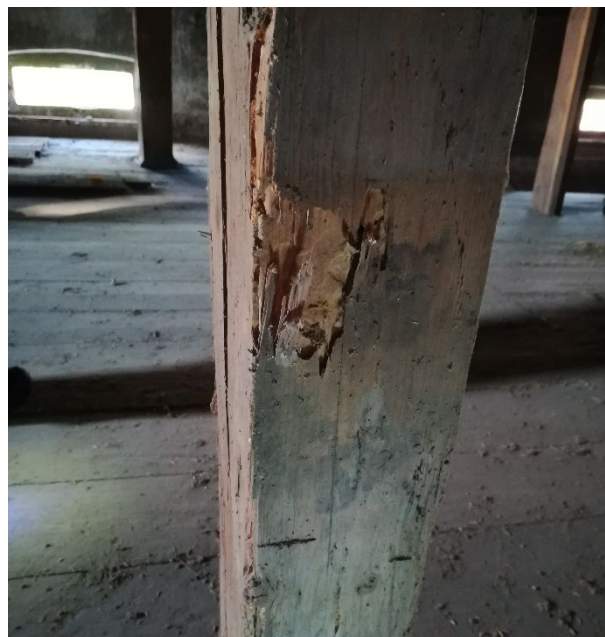
Obr. 64 Napadená část pomocného sloupku krovu
