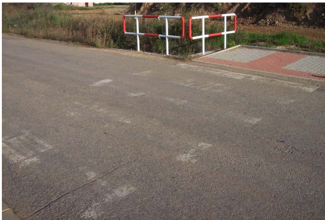
7. Příčná úzká trhlina
