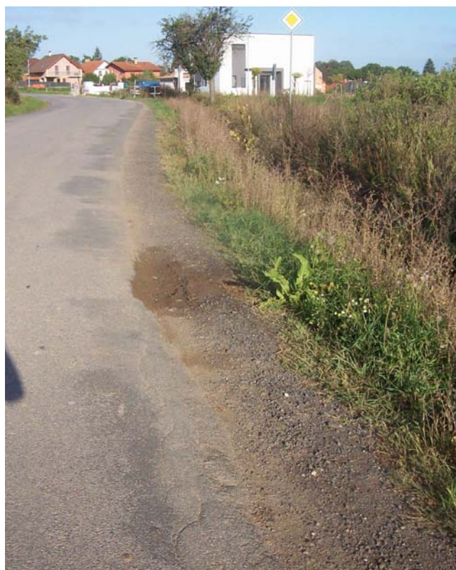
6. Vymílání nezpevněné krajnice
