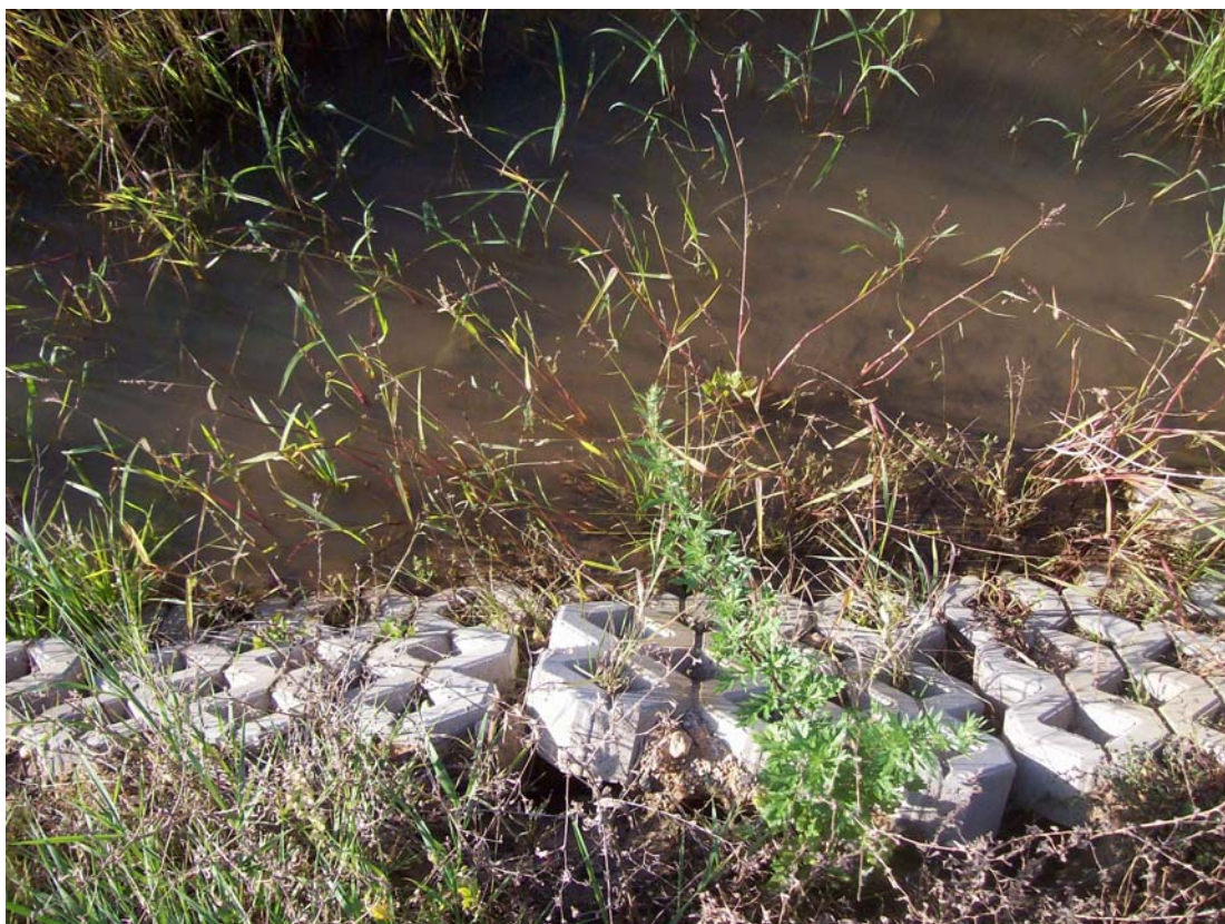
13. Zadržení vody v příkopu
