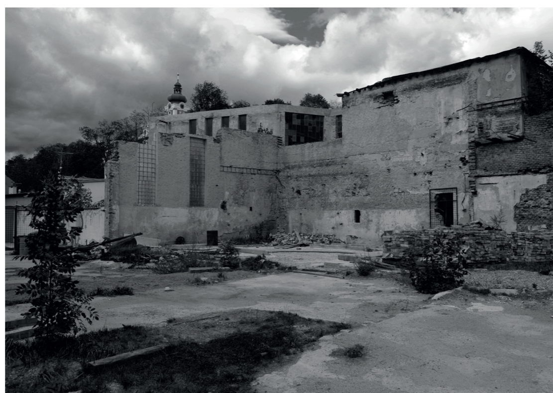
dezolátní stav dvora areálu
