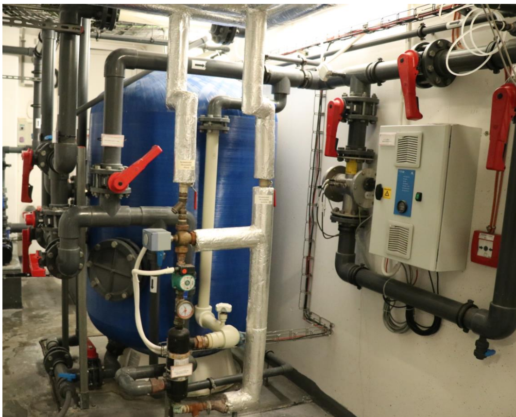
Obr. 51 Umístění UV lampy řešeného bazénového provozu na by-passu za filtrem a ohřevem vody
