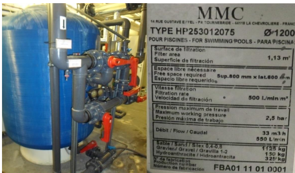
Obr. 46 Pískový rychlofiltr řešeného recirkulačního systému a štítek parametrů udávaných výrobcem
