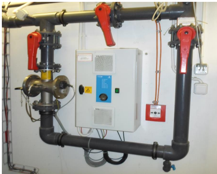
Obr. 50 Umístění UV lampy řešeného bazénového provozu - by-pass
