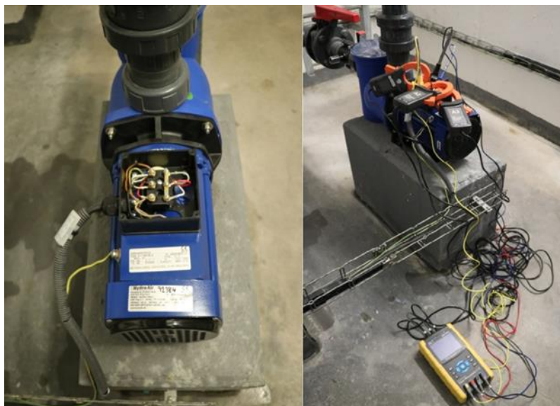
Obr. 56 Napojení analyzátoru výkonu na pohon čerpadla
