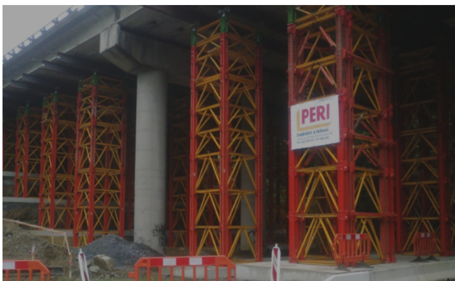
Obrázek 3.2: Havarijní podepření původního mostu D1-035 a jeho původní řešení spodní stavby. Obrázek převzat z [10].
