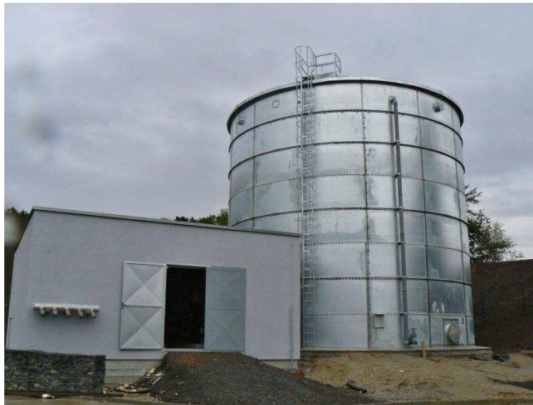
Obr. 4 – Nadzemní nádrž a strojovna sprinklerového stabilního hasicího zařízení [2]
