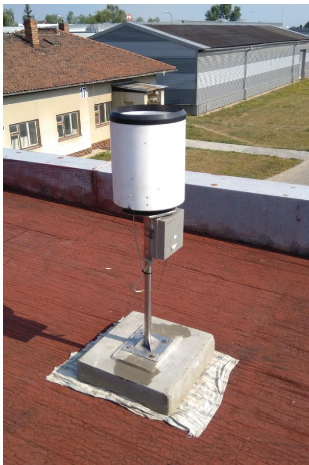
Obrázek 62: Osazený srážkoměr na střeše budovy č. 18 [fotografie autorky]
