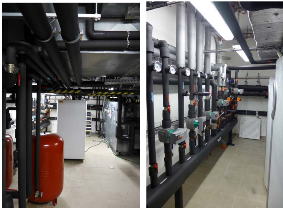
Obr. 64: Vinařství Salabka – vlevo pohled na celou technickou místnost, vpravo rozdělovač a sběrač topného systému [foceno: 4.12.2019, Vinařství Salabka, Praha-Trója]
