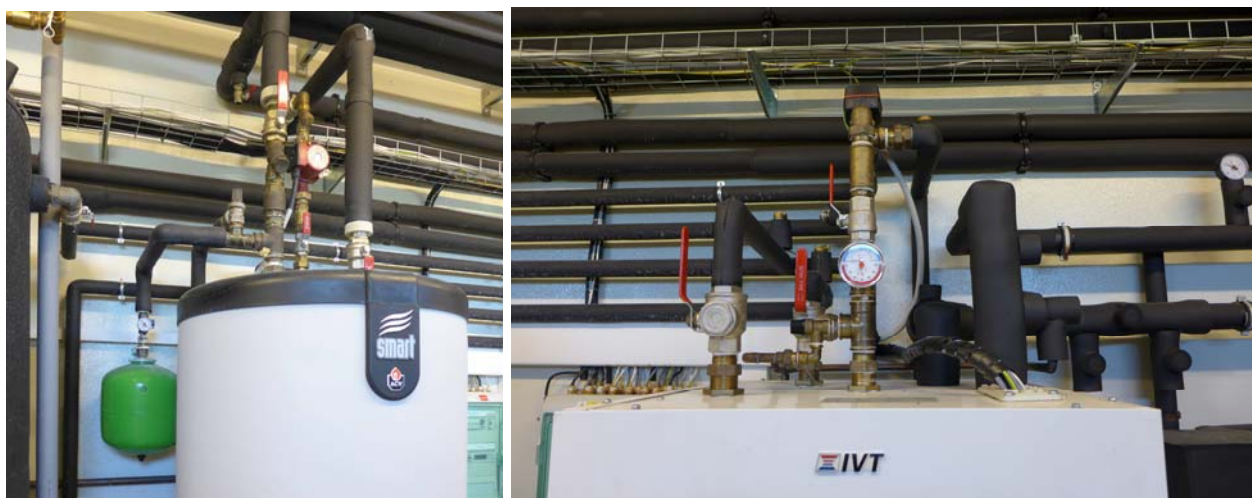
Obr. 19: Vpravo detail napojení zásobníku TV, vpravo detail napojení TČ [foceno: 26.7.2019, Vinařství Šlechtitelka, Velké Pavlovice]
