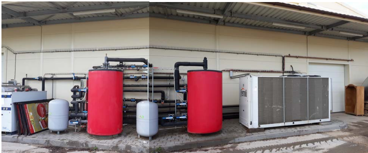
Obr. 45: Pohled na techn. zařízení pro technologii chlazení [foceno: 11.10.2019, Vinařství ANNOVINO, Lednice]
