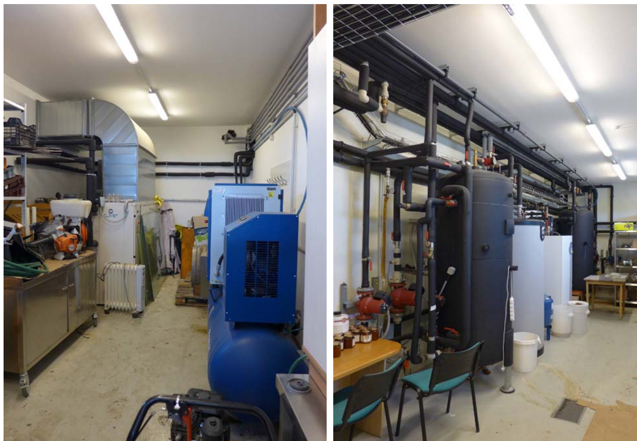
Obr.17: Vpravo příruční sklad – chladič a kompresor, vlevo technická místnost - TČ, AKU teplo, AKU chlad, zásobník TV [foceno: 26.7.2019, Vinařství Šlechtitelka, Velké Pavlovice]
