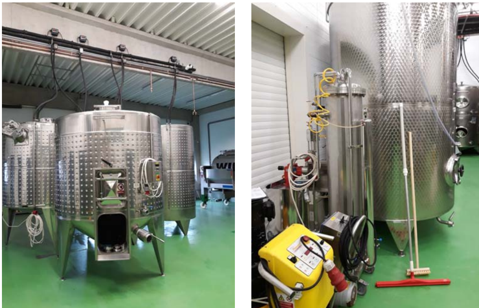
Obr. 56: Vlevo vinifikátory, vpravo sanitální zařízení [foceno: 28.11.2019, Vinařství Volařík, Mikulov]
