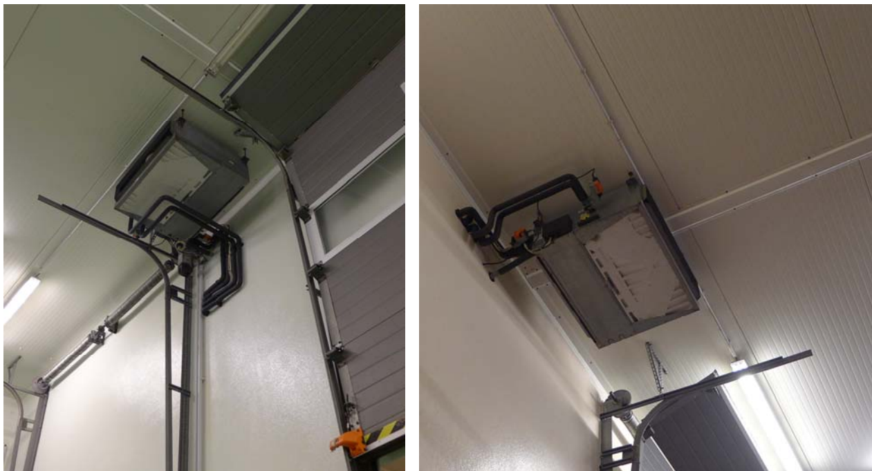
Obr.23: Vlevo fancoil v místnosti Zrání – červené víno, vpravo fancoil v místnosti Zrání – bílé víno [foceno: 26.7.2019, Vinařství Šlechtitelka, Velké Pavlovice]
