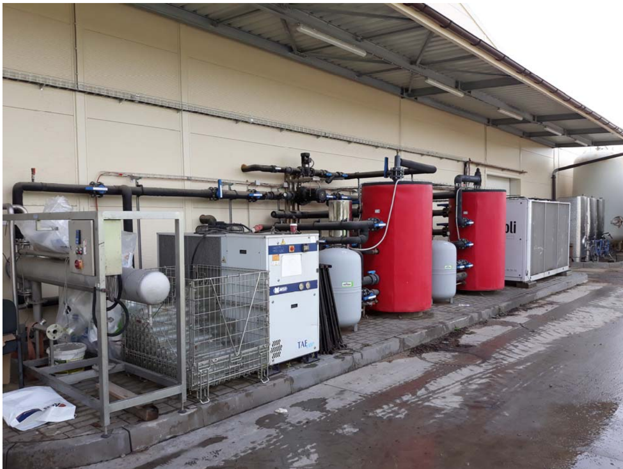
Obr.44: Technické zázemí vně objektu – zařízení umístěná pod přístřeškem [foceno: 11.10.2019, Vinařství ANNOVINO, Lednice]
