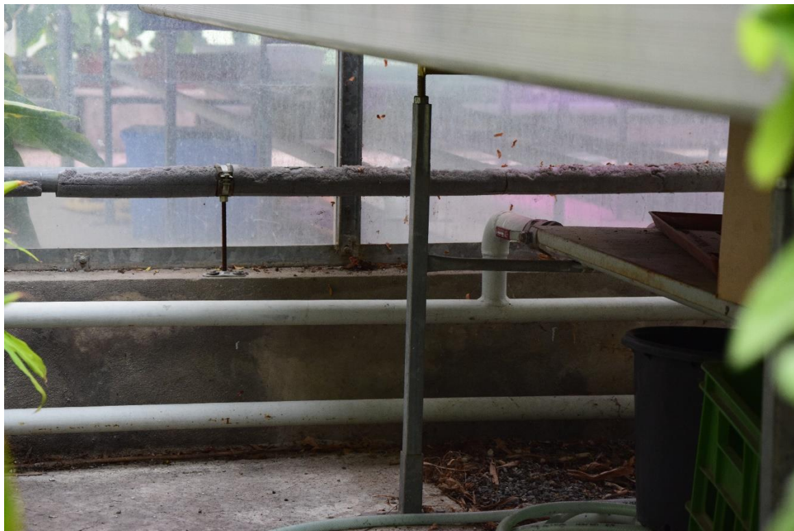
Obr. 10 Detail fotografie interiéru skleníku (topný okruh pod stoly – uzavírací ventil)
