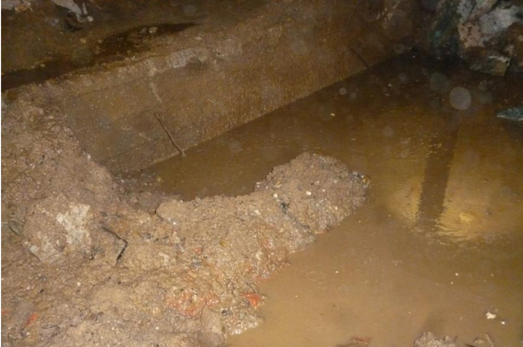
Obrázek 7 Štěrkový podsyp obsahující velké množství vody, Zdroj: Projektová dokumentace – Příloha č. 2 ke změnovému listu ZL10A
