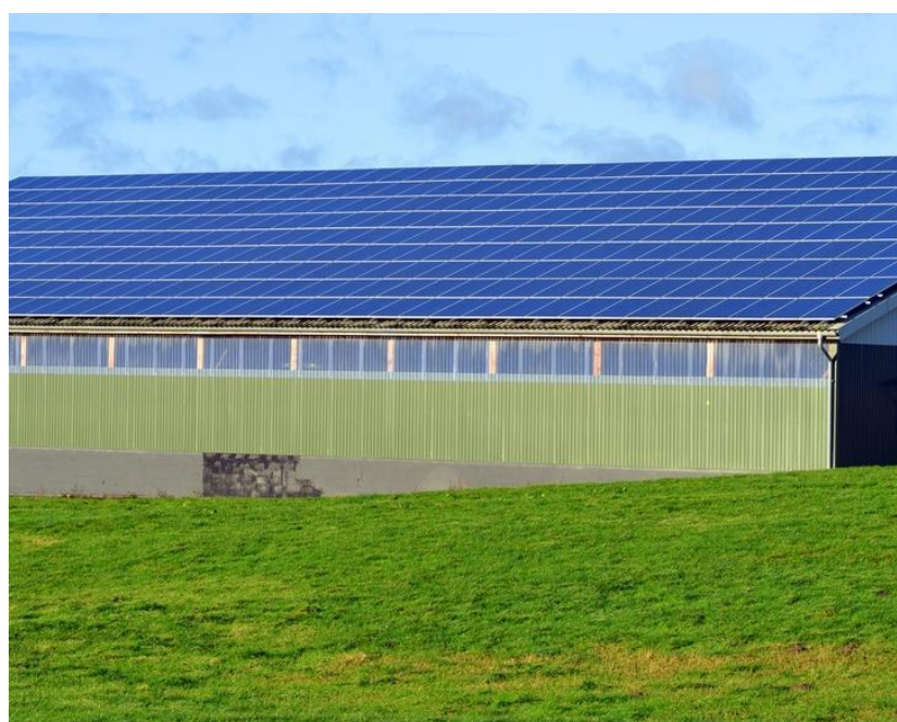
Obrázek č. 25: Příklad velké střešní instalace. [17]
