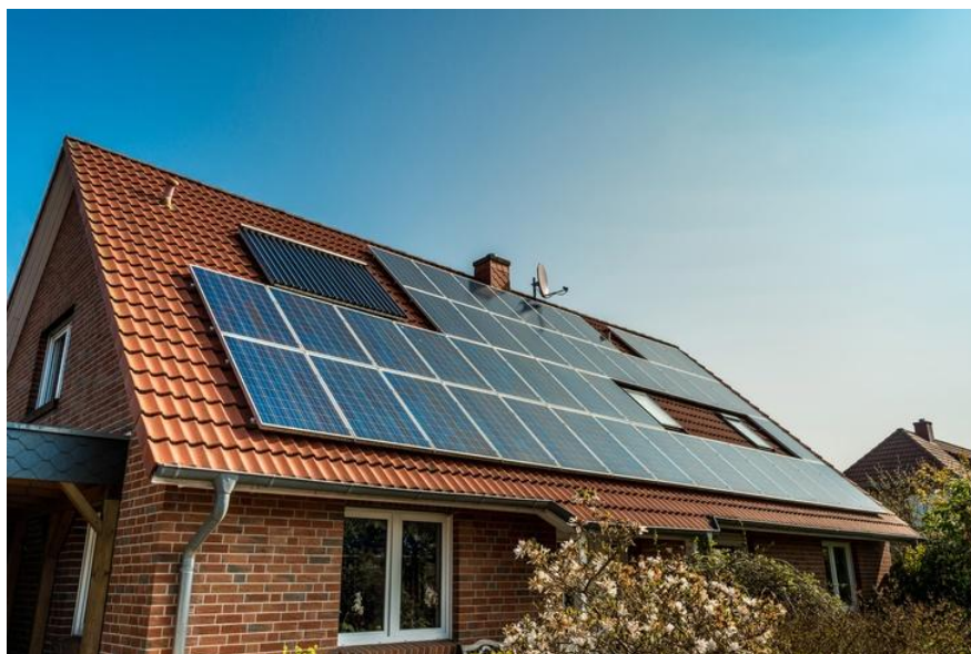
Obrázek č. 24: Příklad malé střešní instalace. [17]
