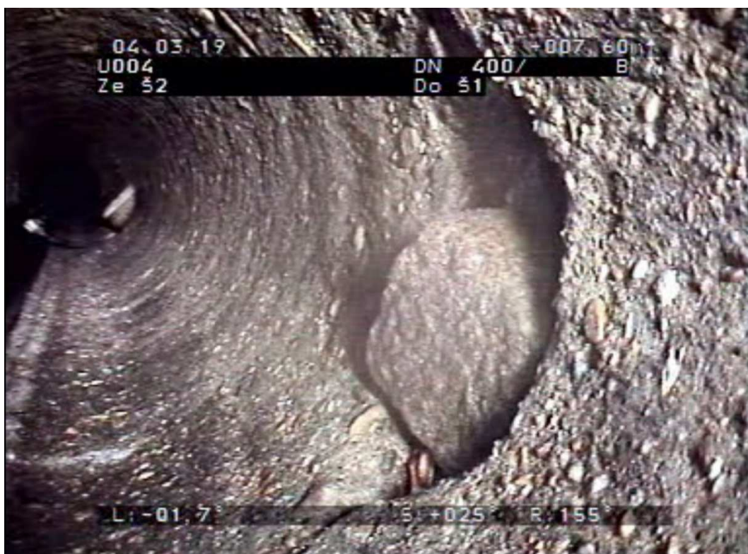
Obrázek č. 37: Přípojka ucpaná žulovou kostkou v úseku Š2 – Š1 [Zepris s.r.o.]
