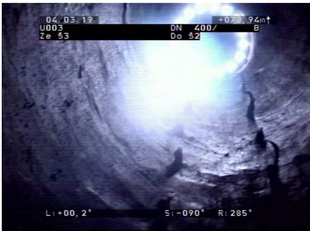
Obrázek č. 38: Šachtové stupačky v havarijním stavu v Š2 [Zepris s.r.o.]
