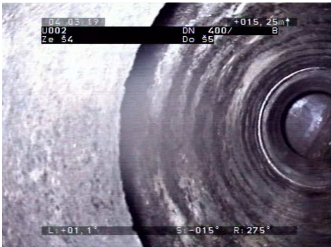
Obrázek č. 36: Netěsnost spoje v úseku Š4 – Š5 [Zepris s.r.o.]
