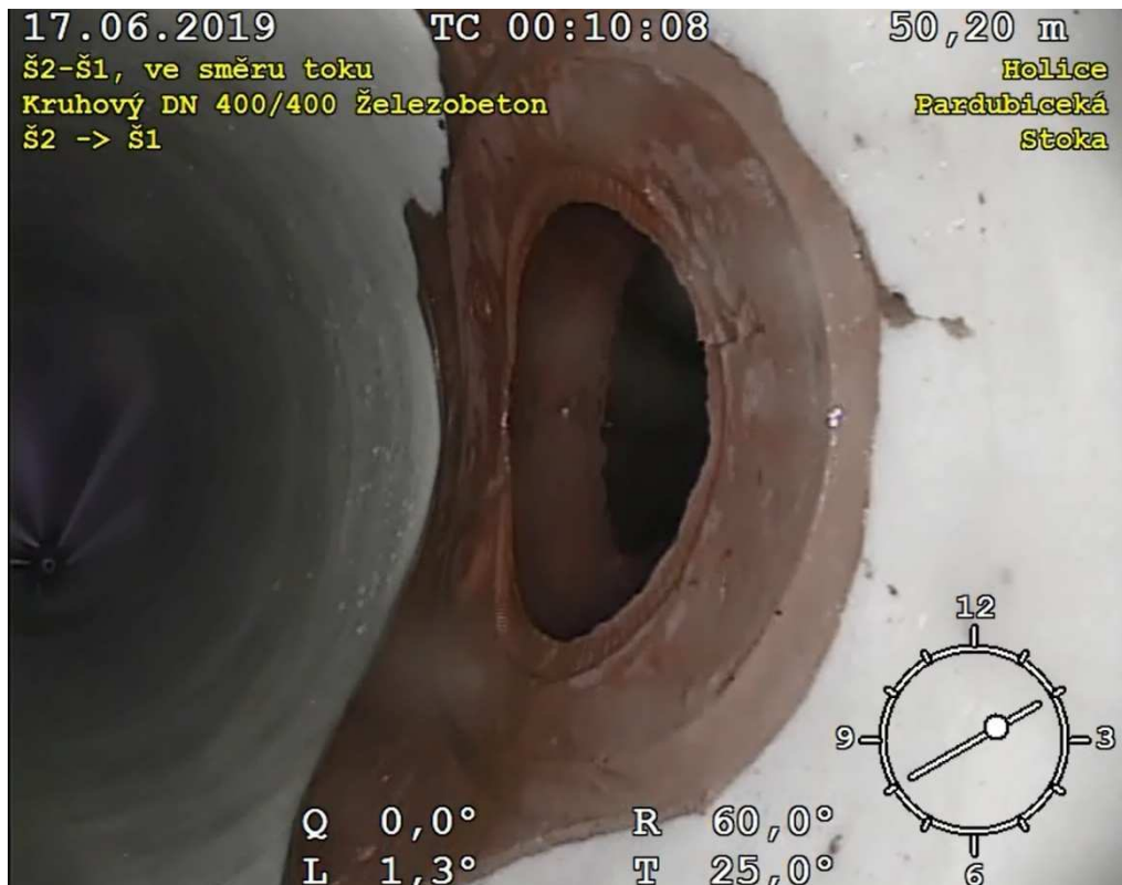
Obrázek č. 45: Utopená přípojka po injektáži ZEP-RE-CON [Zepris s.r.o.]
