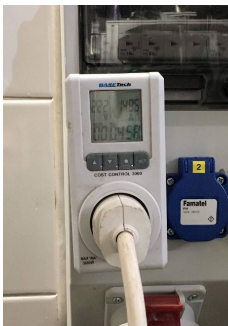
Obrázek 4.1-7 - Elektroměr pro elektrický ohřev sušárny
