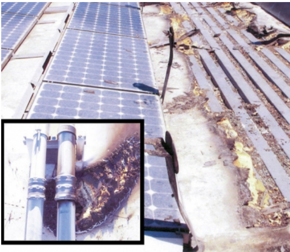
Obrázek 1.1 - Výsledek požáru 383 kW FVE, Bakersfield, CA, USA 2009 [2]
