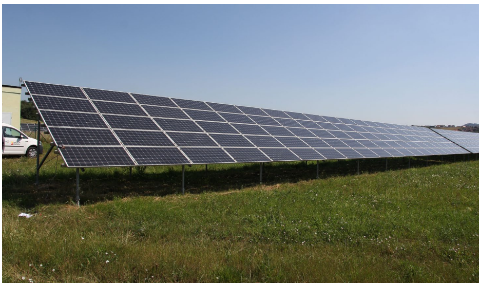
Obrázek 2.5 – Fotografie jednoho z 81 bloků v elektrárně: 5x17 + 1x15 modulů zapojených na jeden střídač, elektrárna Onyx II
