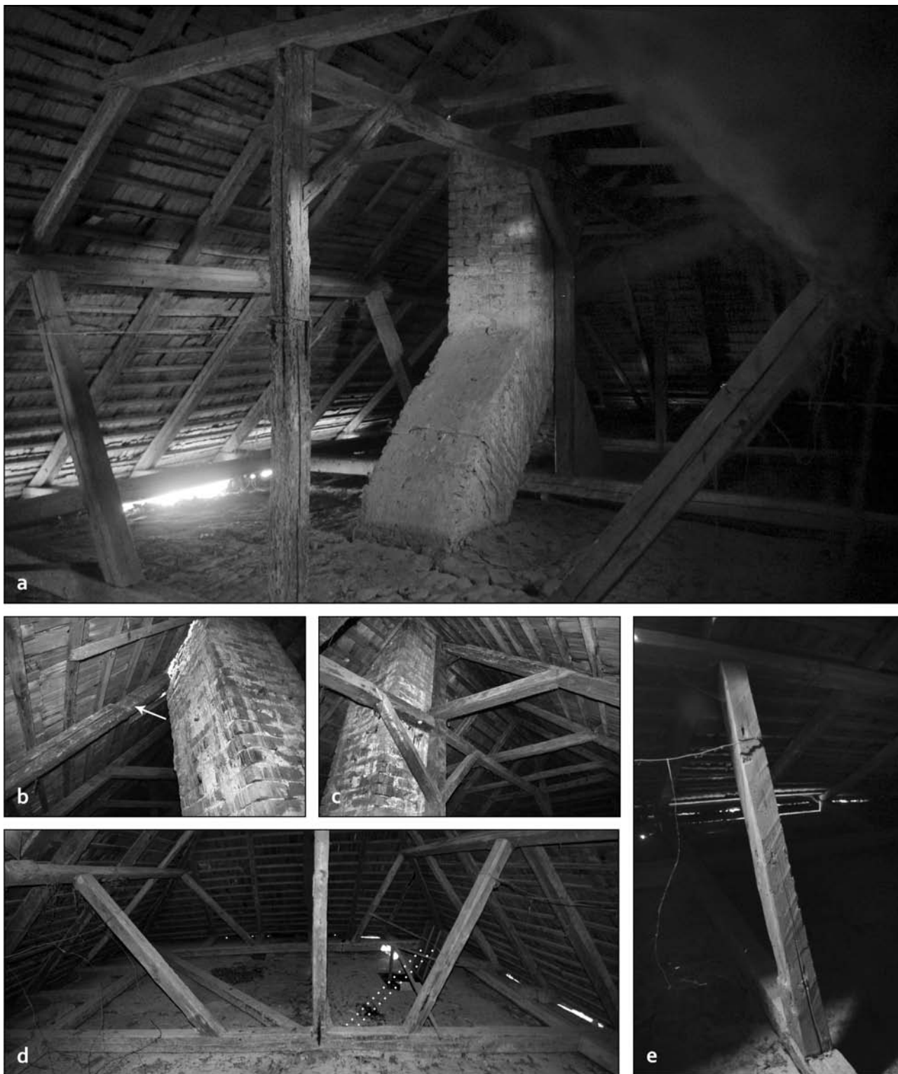
Obr. 21: Krišovská Liesková-Križany (okr. Michalovce), č. 67, krov hambáľkovej konštrukcie s centrálnym vešadlom a stredovými väznicami na šikmých stĺpkoch: a – pohľad do východnej časti krovu, v strede nohavicový komín nad kuchyňou; b – severná hrana komína a pri jeho vložení zrezaná krokva prostrednej plnej väzby, šípka označuje prázdny dlab po hambáľku; c – západná hrana komína a pri jeho vložení skrátenejší hambáľok. Do vešiaka sú plátované pásiky a hambáľok a čapované rozpory a krokvy; d – prahový trámový rošt krovu pod SZ valbou. Severný diagonálny väzný trám (vpravo) bol pri prerazení druhotného výstupu na krov skrátenejší na kútový úsek; e – šikmý stĺpik pod väznicou, stopy po tesárskom opracovaní ( a : foto autor 2016, b – e : foto autor 2019).
