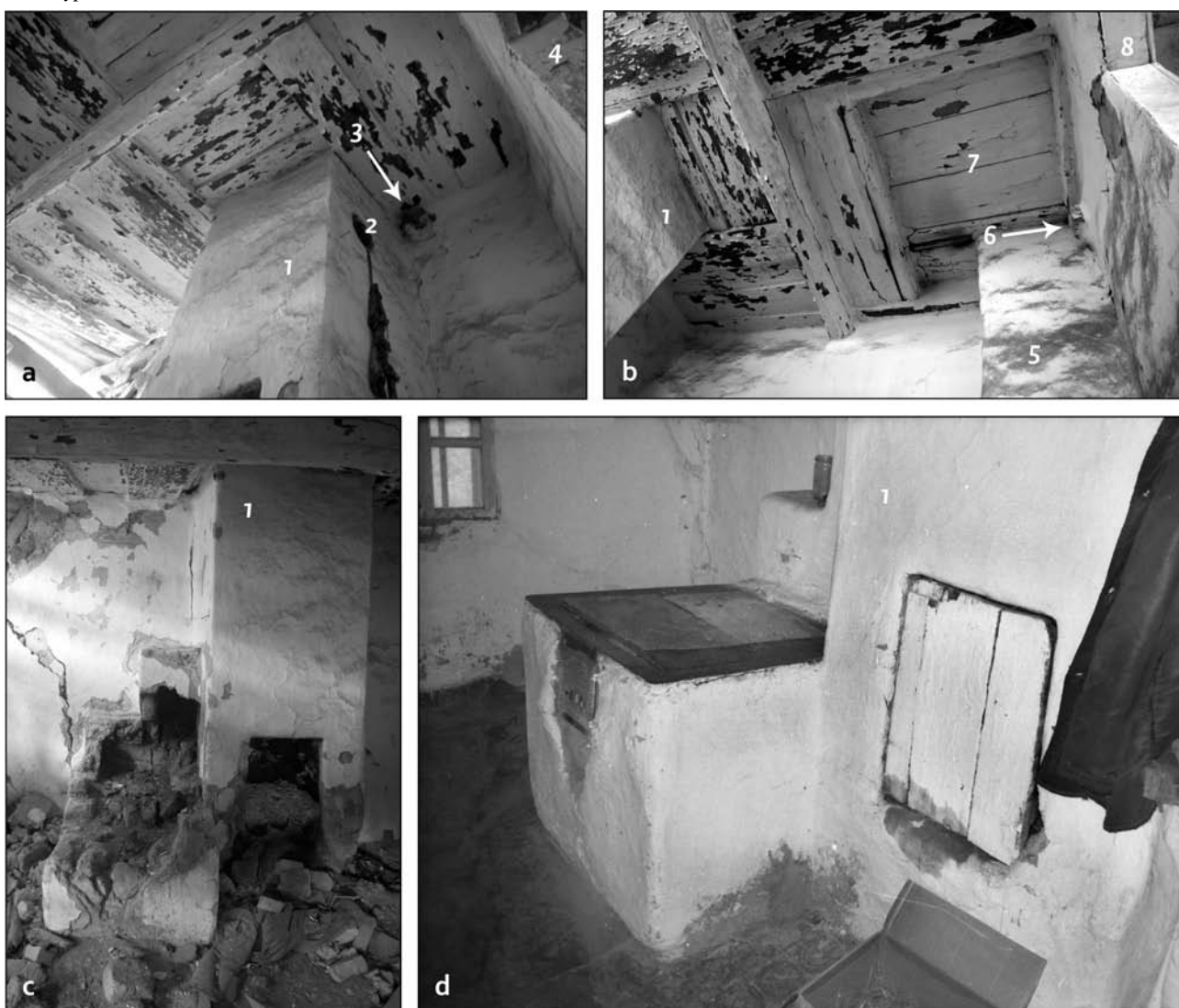
Obr. 11: Koromľa (okr. Sobrance), č. 114, kuchyňa (miestnosť č. II): a – pohľad do JV časti stropu; b – pohľad do JZ časti stropu; c – zvyšky sporáku; d – sporák v r. 1997 ( a – c : foto autor 2018; d : foto V. Sinčáková 1997, zdroj: citácia v pozn. 12, č. neg. 110): 1 – komín oddymujúci sporák a nezachované piecky v tejto a v m. č. V, dole bol predpecím pre pec za stenou, v m. č. VI; 2 – dymový otvor dokladajúci niekdajšiu piecku v kuchyni, zrejme v južnom kúte pod ním; 3 – čelo vencovej ližiny priečky deliacej zadné travé na miestnosti č. V a VI; 4 – zárubňa dverí medzi kuchyňou (II) a predsieňou (I); 5 – komín v západnom kúte oddymujúci nezachovanú piecku za stenou, v izbe predného travé (IV); 6 – čelo vencovej ližiny priečky deliacej predné travé na izbu (IV) a komoru (III); 7 – niekdajší výstupný otvor na povalu; 8 – zárubňa dverí medzi kuchyňou (II) a komorou (III).
