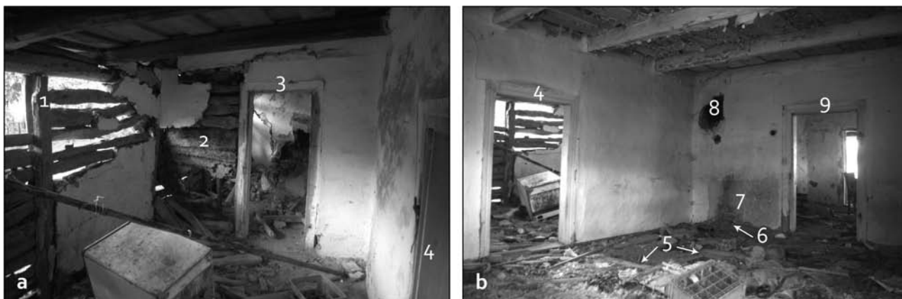
Obr. 12: Koromľa (okr. Sobrance), č. 114, miestnosti predného travé: a – komora (III), pohľad do JV časti (foto autor 2018); b – predná izba (IV), pohľad do východnej časti (foto autor 2018): 1 – stĺpik so zvrchu potvorenou drážkou pre vloženie najvrchnejších palaniek; 2 – otláčok výplne priečky v hlinenej omietke; 3 – zárubňa dverí do kuchyne (II) s deštrukciou sporáka v priezore; 4 – zárubňa dverí do prednej izby (IV); 5 – podvaly nezachovanej drevenej podlahy; 6 – čelo prahovej ližiny priečky deliacej stredné travé na predsieň (I) a kuchyňu (II), kolmo preplátovanej s ližinou priečky medzi predným a stredným travé; 7 – obrys piecky či sporáka v poslednej maľovke; 8 – deštruovaný dymový otvor do komína v západnom kúte kuchyne (II); 9 – dvere do predsieň (I), v priehlade dvere do prednej izby zadného travé (V).
