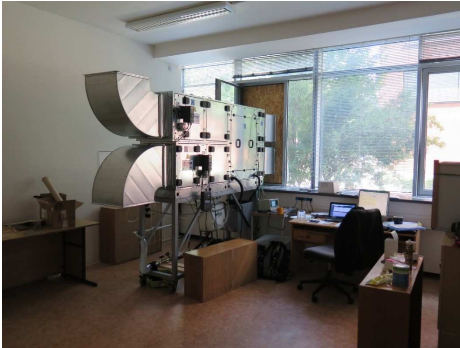
Obr. 36 – Experimentální VZT jednotka v provozu
