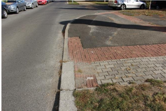
Obr. 38 : Úsek č. 29 – Chybně provedené bezpečnostní prvky pro nevidomé a slabozraké na místě pro přecházení 65
