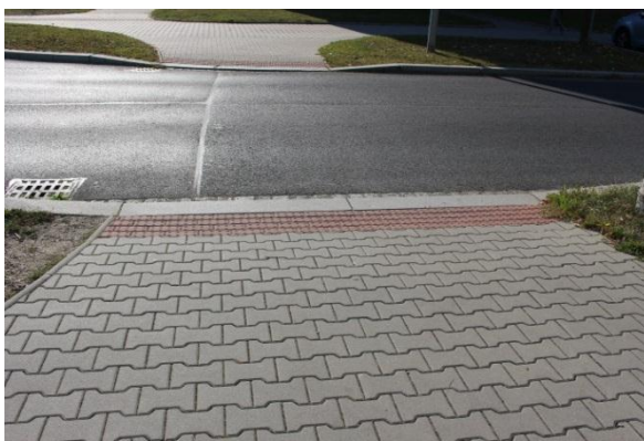
Obr. 40 : Úsek č. 32 – Chybně provedené bezpečnostní prvky pro nevidomé a slabozraké na místě pro přecházení 66
