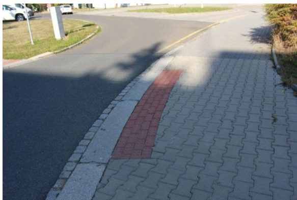
Obr. 41 : Úsek č. 33 – Chybně provedené bezpečnostní prvky pro nevidomé a slabozraké na místě pro přecházení 67
