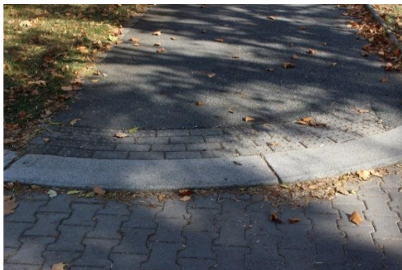
Obr. 52 : Úsek č. 52 – Chybně provedené bezpečnostní prvky pro nevidomé a slabozraké na místě pro přecházení 73
