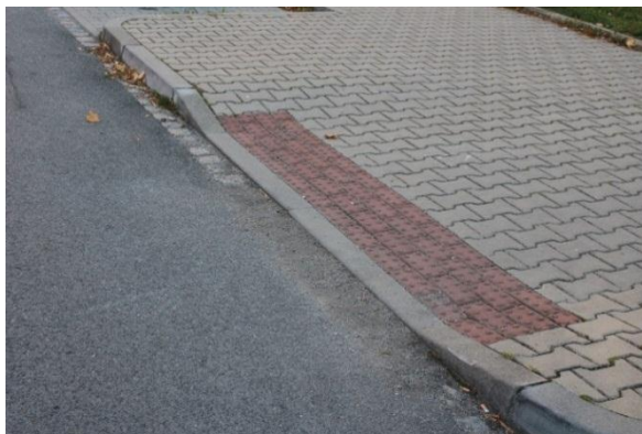
Obr. 45 : Úsek č. 42 – Chybně provedené bezpečnostní prvky pro nevidomé a slabozraké na místě pro přecházení 70
