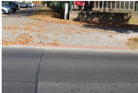
Obr. 54 : Úsek č. 55 – Chybně provedené bezpečnostní prvky pro nevidomé a slabozraké na místě pro přecházení 74
