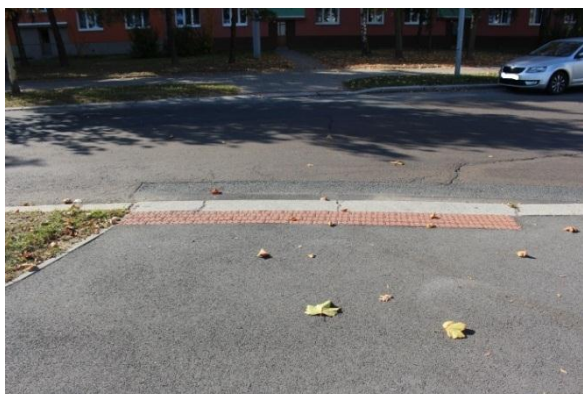
Obr. 42 : Úsek č. 34 – Chybně provedené bezpečnostní prvky pro nevidomé a slabozraké na místě pro přecházení 67
