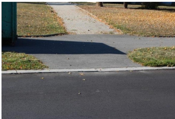
Obr. 51 : Úsek č. 51 – Chybějící bezpečnostní prvky pro nevidomé a slabozraké 73
