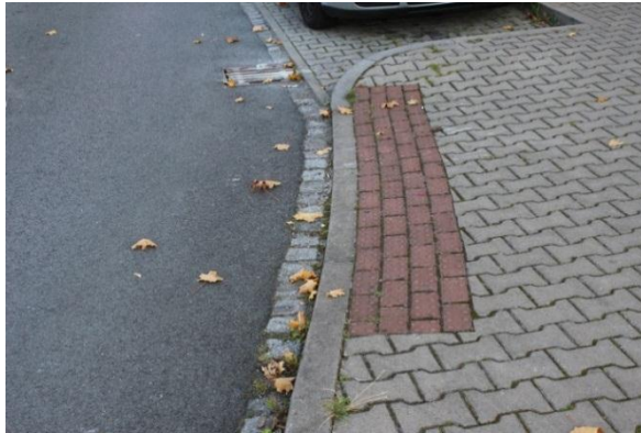
Obr. 44 : Úsek č. 41 – Chybně provedené bezpečnostní prvky pro nevidomé a slabozraké na místě pro přecházení 69
