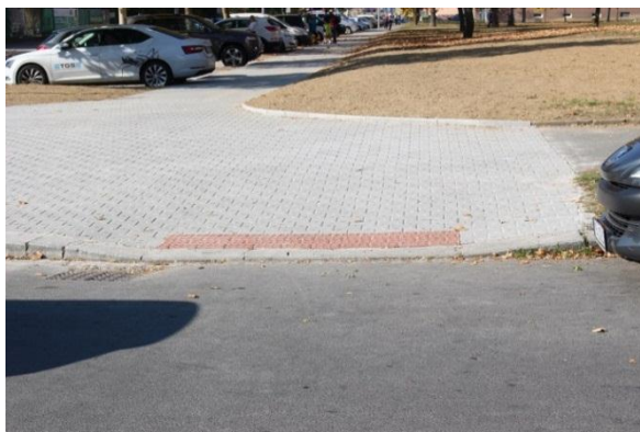
Obr. 28 : Úsek č. 17 – Chybně provedené bezpečnostní prvky pro nevidomé a slabozraké na místě pro přecházení 59
