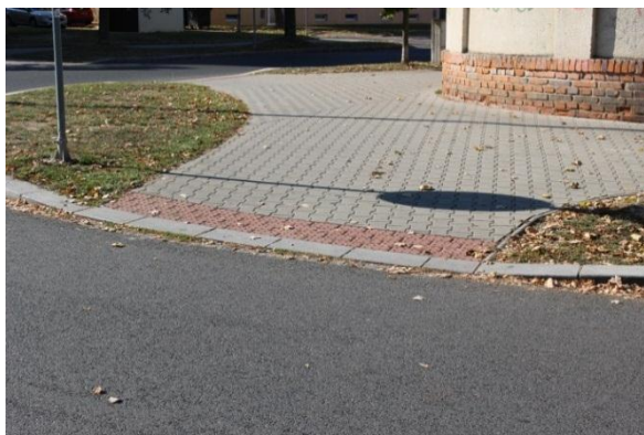
Obr. 32 : Úsek č. 25 – Chybně provedené bezpečnostní prvky pro nevidomé a slabozraké na místě pro přecházení 61
