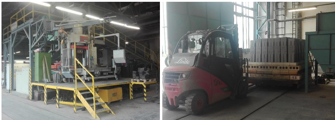
Obr. 35: Pracoviště hydraulického lisu společně s pásovým dopravníkem a transport pecního vozu po průběžné koleji prostřednictvím VZV.
