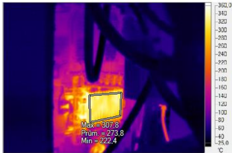
Obrázek 30: Termografický snímek výměníku před postříkem
