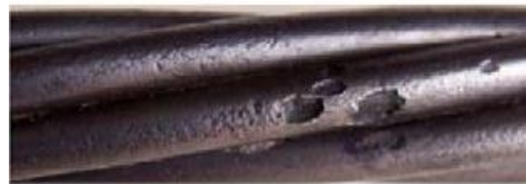
Obr. 14 Bodová koroze předpínacího lana [28]
