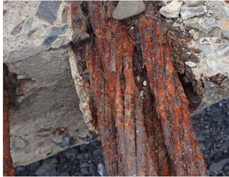
Obr. 12 Rovnoměrná koroze předpínacího lana (foto: doc. Ing. Pavel Ryjáček PhD.)
