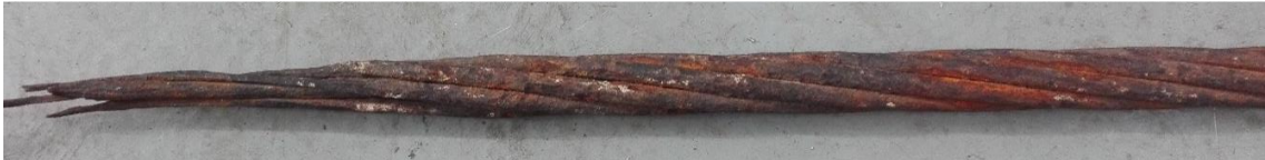
Obr. 68 Poškozené předpínací lano (foto: Tomáš Dejmek)
