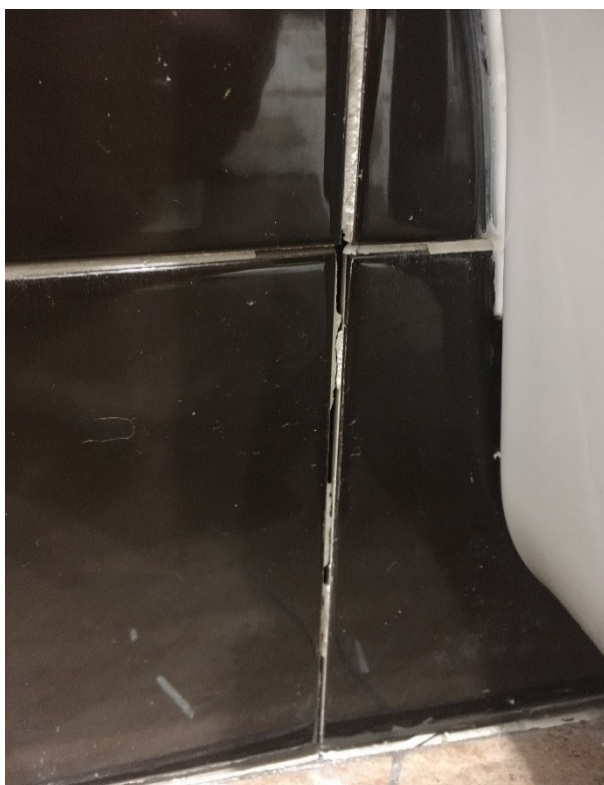
Obr. 22 Vypadaná spárovací hmota za WC
