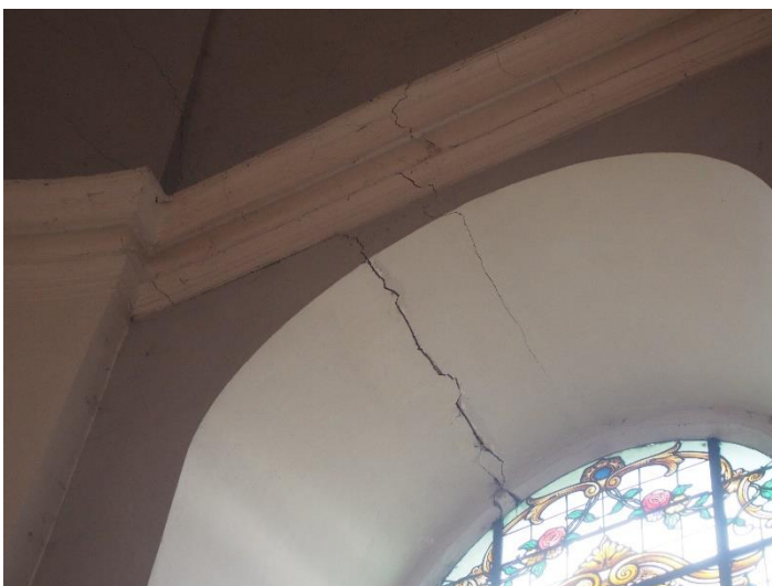
Obrázek 3.17 - Trhlina v nadpraží východního okna, hlavní loď
