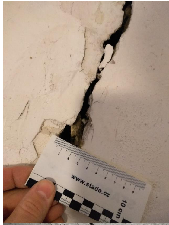
Obrázek 4.20-Trhlina v sakristii (východní stěna)
