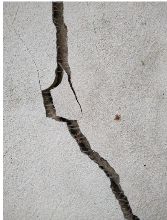
Obrázek 3.32 - Výztužná tkanina ve vnější omítce (trhlina sakristie)
