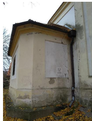
Obrázek 3.8 - Vzlínající vlhkost, odstříkující voda, trhlina - sakristie
