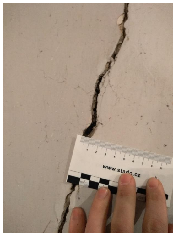
Obrázek 4.26-Trhlina pod oknem, presbytář
