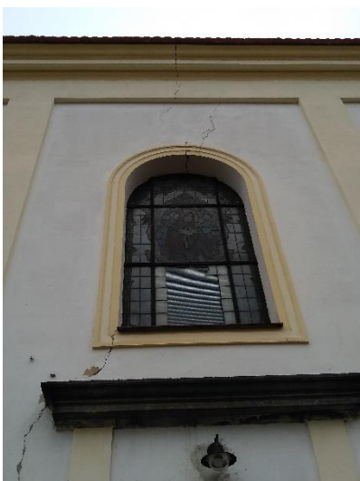
Obrázek 3.16 - Trhlina v nadpraží a parapetu, okno nad vchodem do lodi
