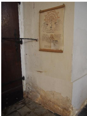
Obrázek 3.7 - Vzlínající vlhkost, vchod do věže z hlavní lodi
