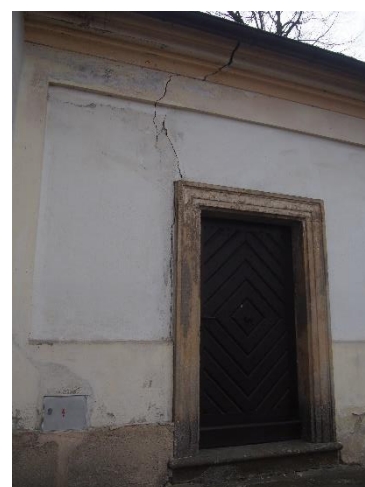
Obrázek 3.11 - Trhliny, vchod do sakristie
