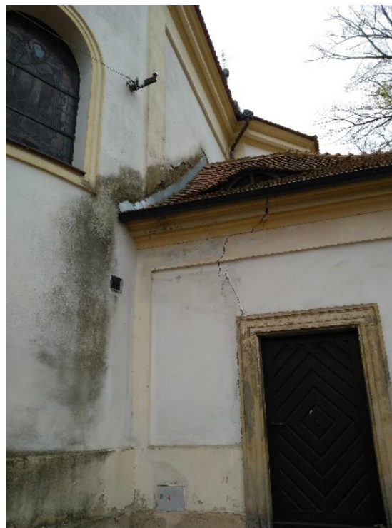
Obrázek 4.31-Stav vnějších omítek+trhliny, sakristie
