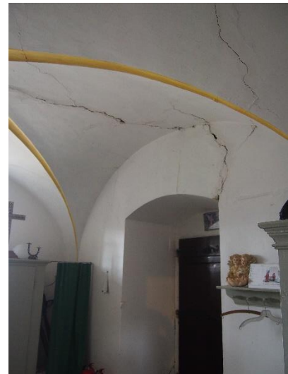
Obrázek 3.15 - Klenba sakristie s trhlinou
