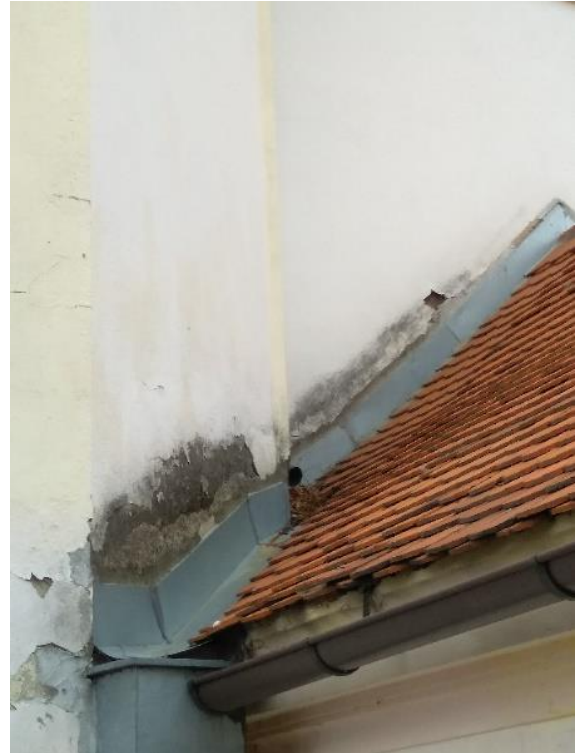
Obrázek 4.1-Degradace omítek ve styku střechy kaple a hlavní lodi (resp. presbytáře)
