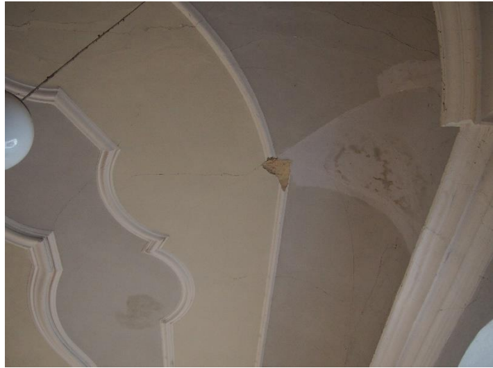
Obrázek 3.13 - Nepravá zrcadlová klenba hlavní lodi – opadaná omítka, stopy zatékání, praskliny
