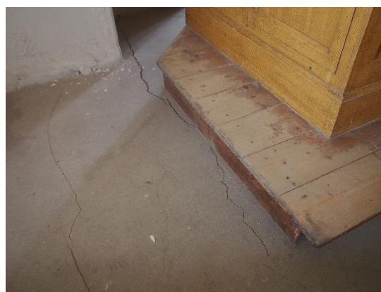
Obrázek 3.36 - Podlaha kruchty, trhliny
