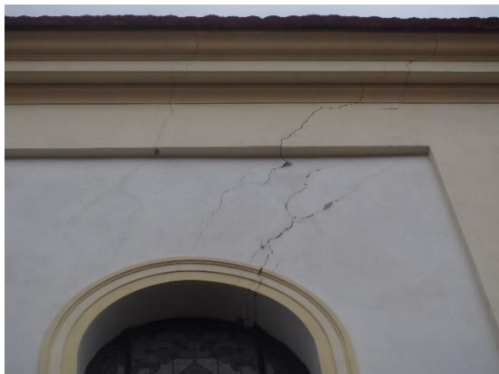
Obrázek 4.23-Trhliny nad východním oknem, hlavní loď
