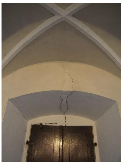
Obrázek 3.18 - Trhlina v nadpraží, vchod do věže z lodi
