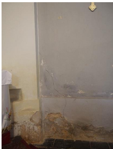
Obrázek 3.6 - Vzlínající vlhkost, východní část hlavní lodi
