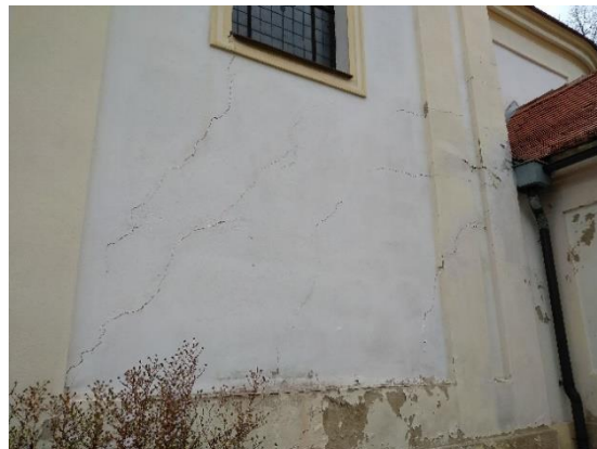
Obrázek 4.24-Trhliny pod východním oknem, hlavní loď
