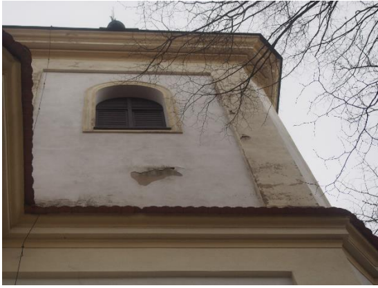
Obrázek 3.30 - Poškození omítky veže
