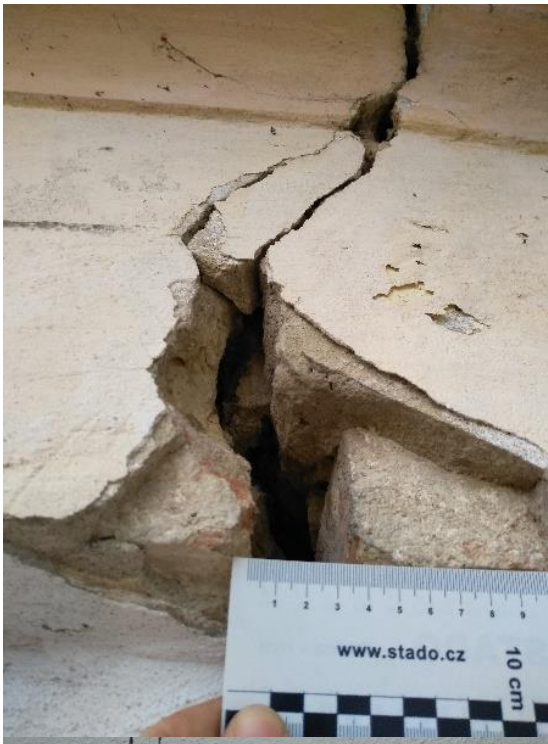
Ob. Obrázek 4.19-Trhlina v sakristii (římsa) vni lodi
