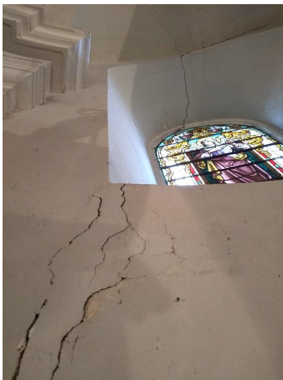
Obrázek 4.25-Trhliny pod a nad oknem, presbytář
