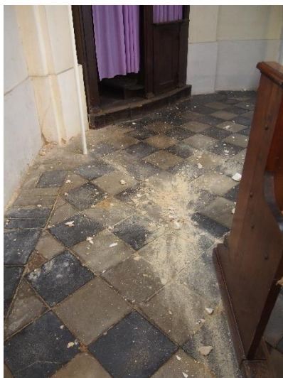
Obrázek 4.29-Podlaha, na kterou dopadla omítka ze stropu
