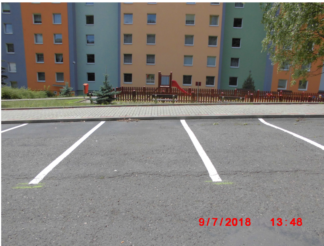
Obrázek 4 - VZD na poškozeném povrchu
