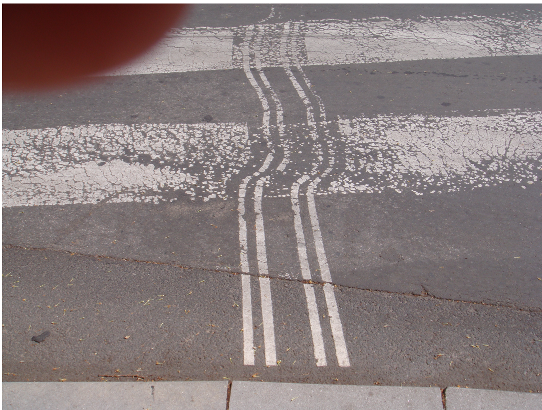
Obrázek 3 - VDZ po deformaci vozovky
