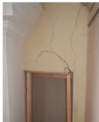
Obr. 64 - Destruktivní stav nadpraží
