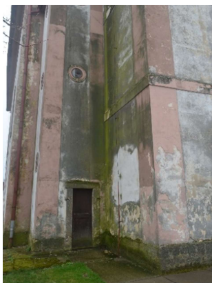
Obr. 53 - Poškození vnitřního rohu
