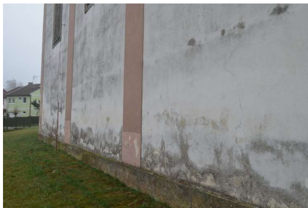
Obr. 54 – Poškození vztlínající vodou
