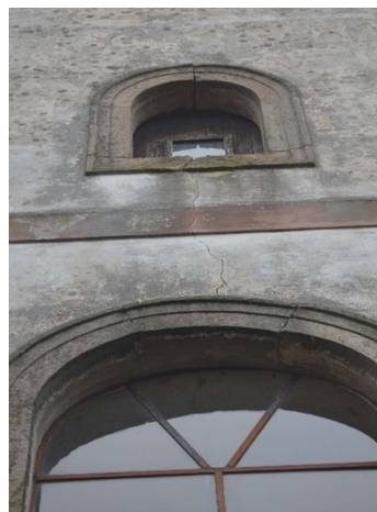
Obr. 58 - Svislé trhliny ve věži
