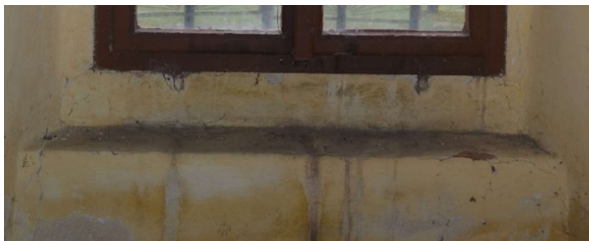
Obr. 52 - Porušený parapet pod oknem
