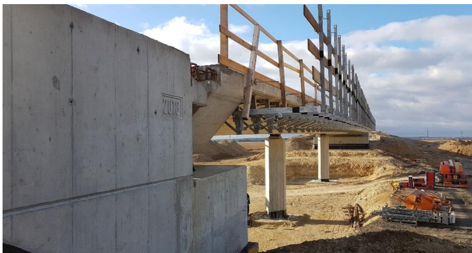
Obrázek 27 Zajištění konstrukce mostu SO 205 proti pádu (Zdroj autor)
