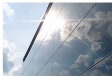
FV PANELE - STŘECHA/FASÁDA
