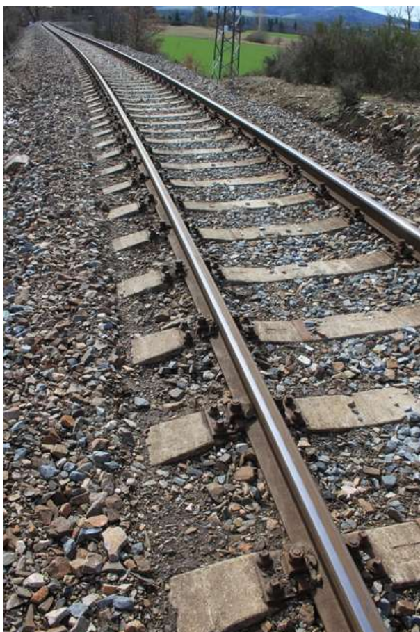
Obr. 36: Stav kolejového lože km 9,600
