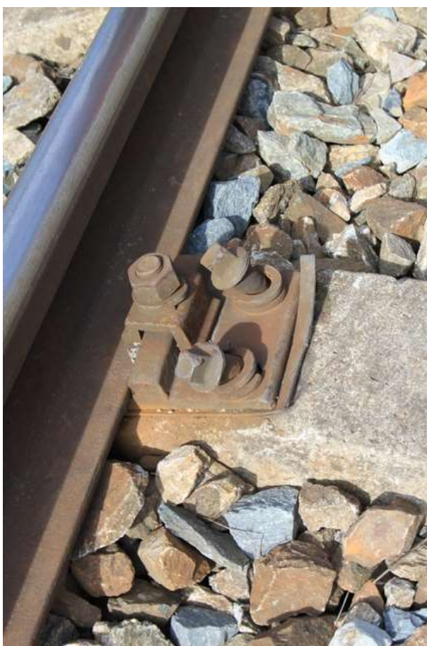
Obr. 34: Stav upevnění km 9,000
