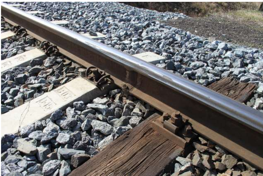
Obr. 48: Stav železničního svršku u přejezdu P5750, km 11,928
