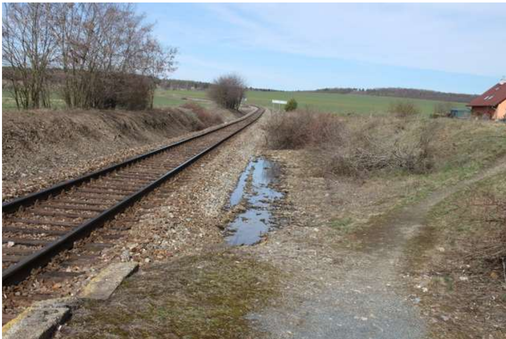
Obr. 46: Nefunkční odvodnění, z. Nová Ves pod Pleší
