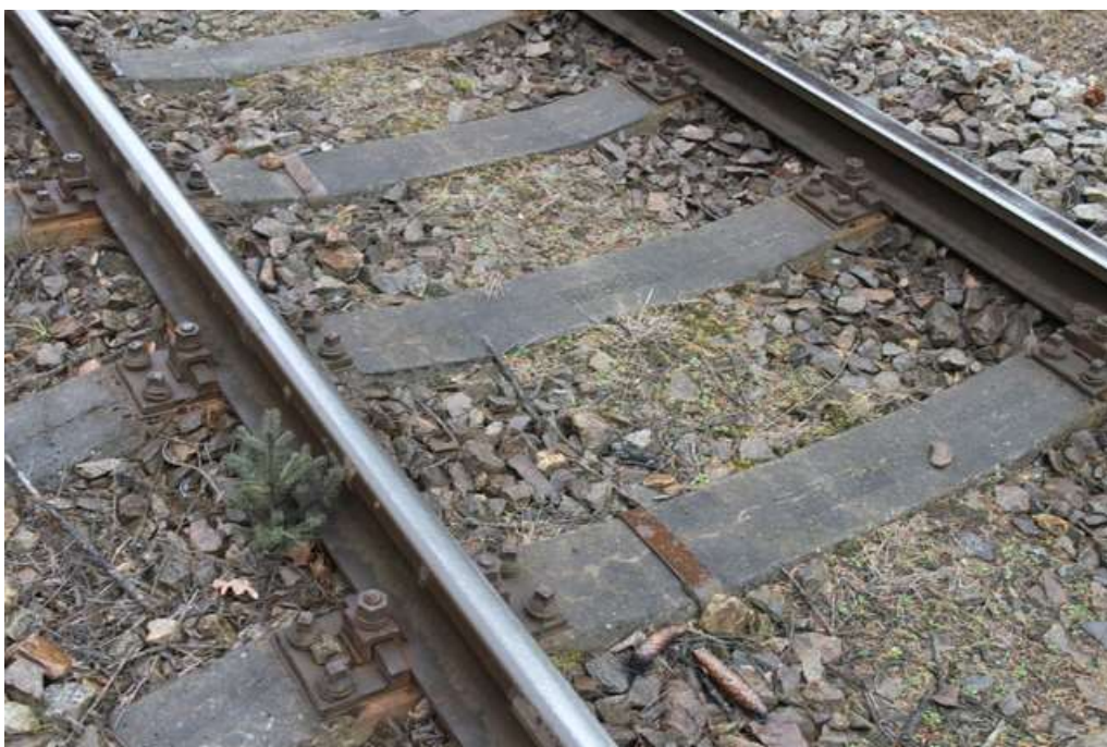
Obr. 16: Znečištěné kolejové lože km 4,900
