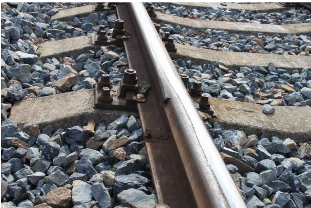
Obr. 40: Svar ojetých kolejnic, km 10,700
