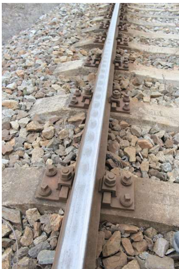
Obr. 14: Vady kolejnic, km 4,000
