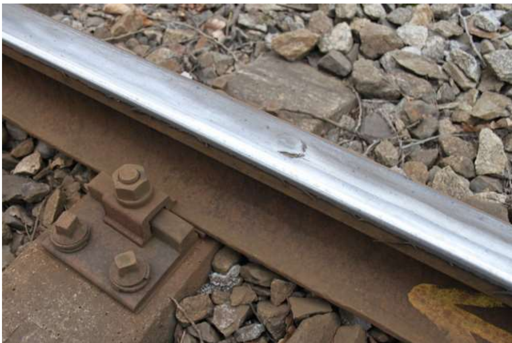
Obr. 12: Vady kolejnic, km 3,800
