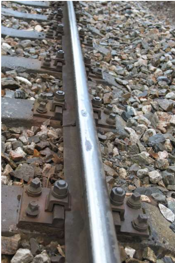
Obr. 23: Vady kolejnic km 6,400
