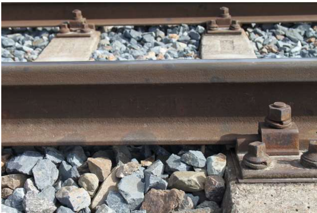
Obr. 39: Kolejnice T km 10,700
