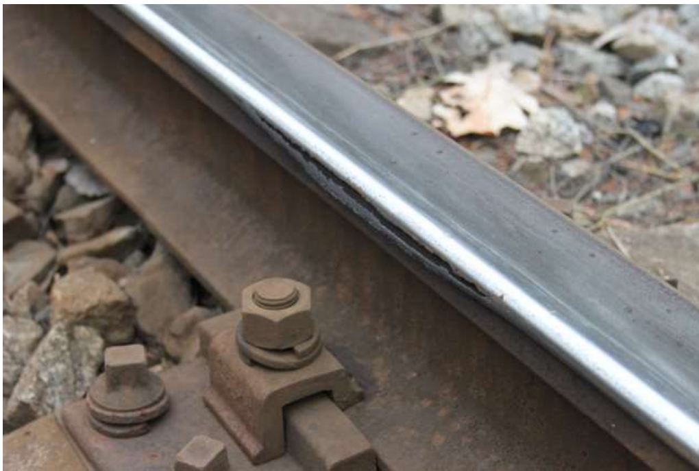
Obr. 11: vady kolejnic, km 3,800
