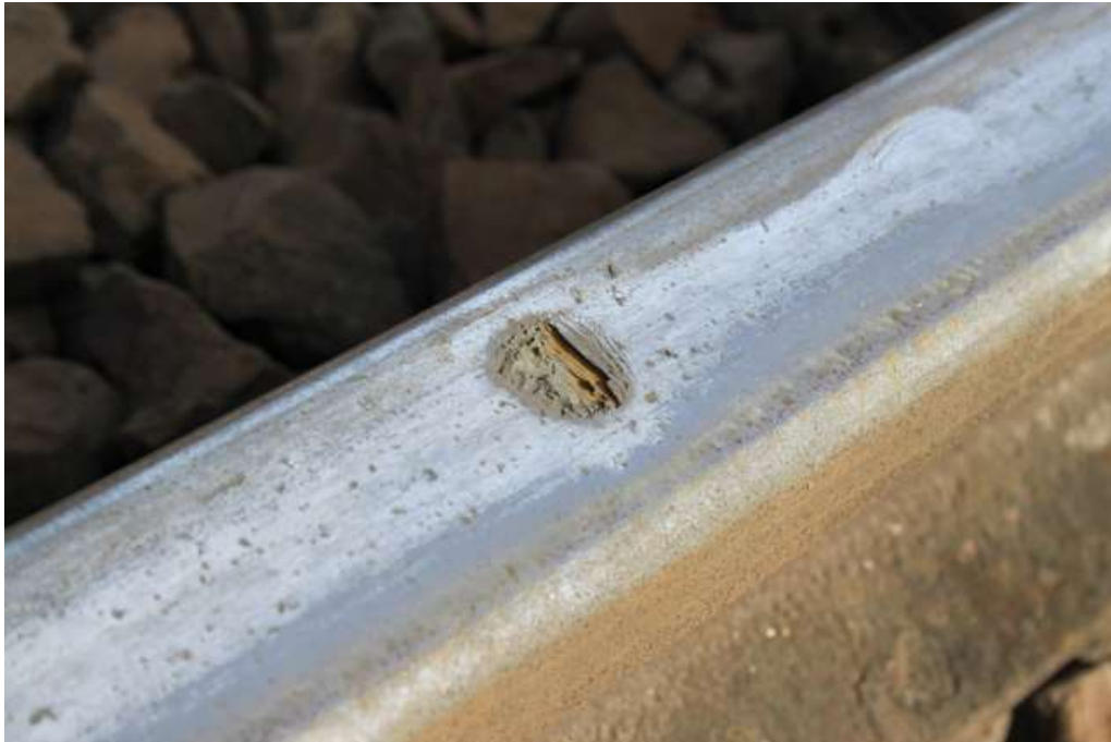
Obr. 31: Vada kolejnice km 8,400
