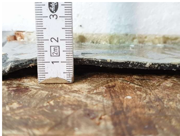
Obr. 31 - Vzduchová mezera pod asfaltovým pásem (zdroj autor)
