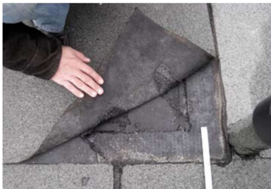
Obr. 12 - Porucha střešního pláště (převzato z [3])
