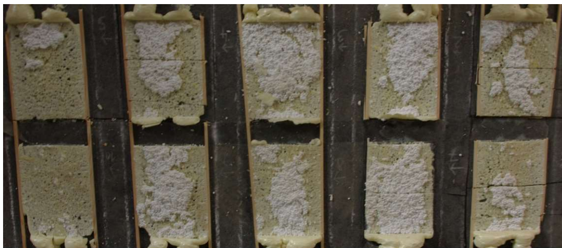
Obr. 39 – Zbylé lepidlo na podkladu po odtrhových zkouškách (zdroj autor)
