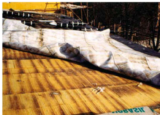
Obr. 13 - Porucha střešního pláště (převzato z [3])
