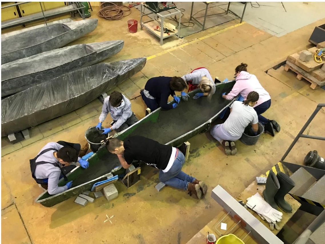
Obr. 7.5 - Průběh čtvrté betonáže, na fotografii studenti SPŠ Dušní, obdobně však vypadala betonáž i v případě prvních tří lodí v pozadí
