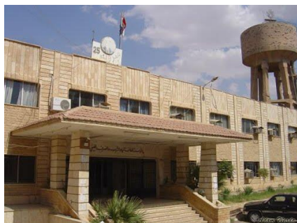
Obrázek 23: Výplně otvorů objektu ve městě Al-Hasakah
