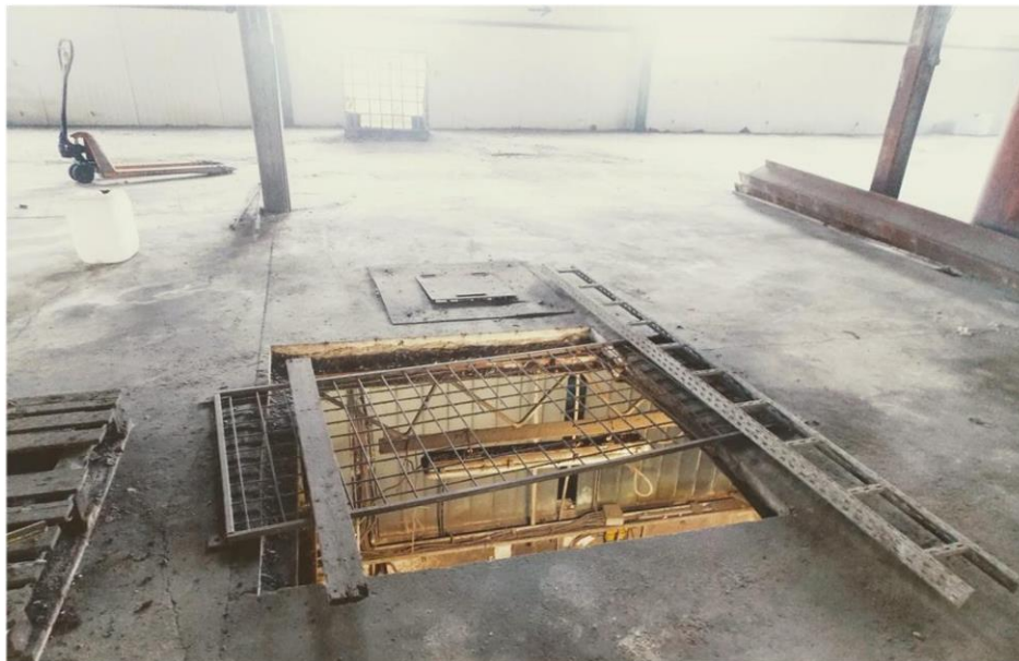
Obr. 3 Nedostatečně zabezpečený otvor v podlaze (Zdroj) [cit 2019/05]
