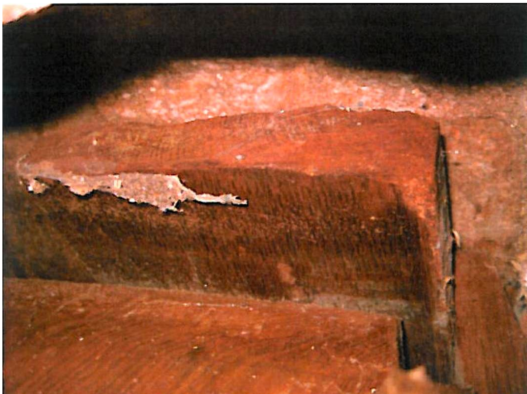
Obr. 44: Sonda 1 - zaplísněný povrch dřeva (Foto: J. Řehák)
