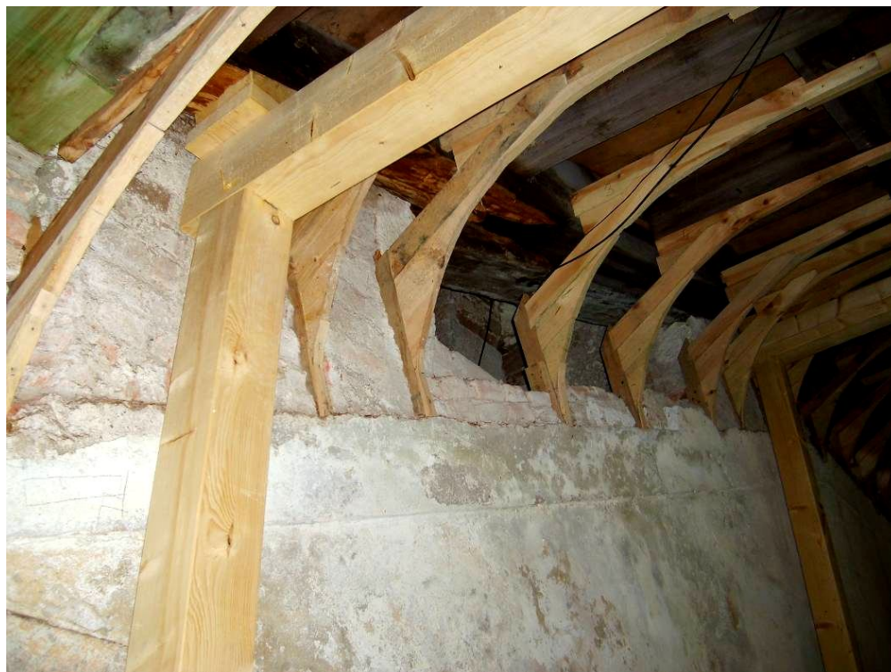
Obr. 40: Poškozené dřevěné konzoly (klíny) Santiniho samonosného schodiště (Foto: J. Řehák)
