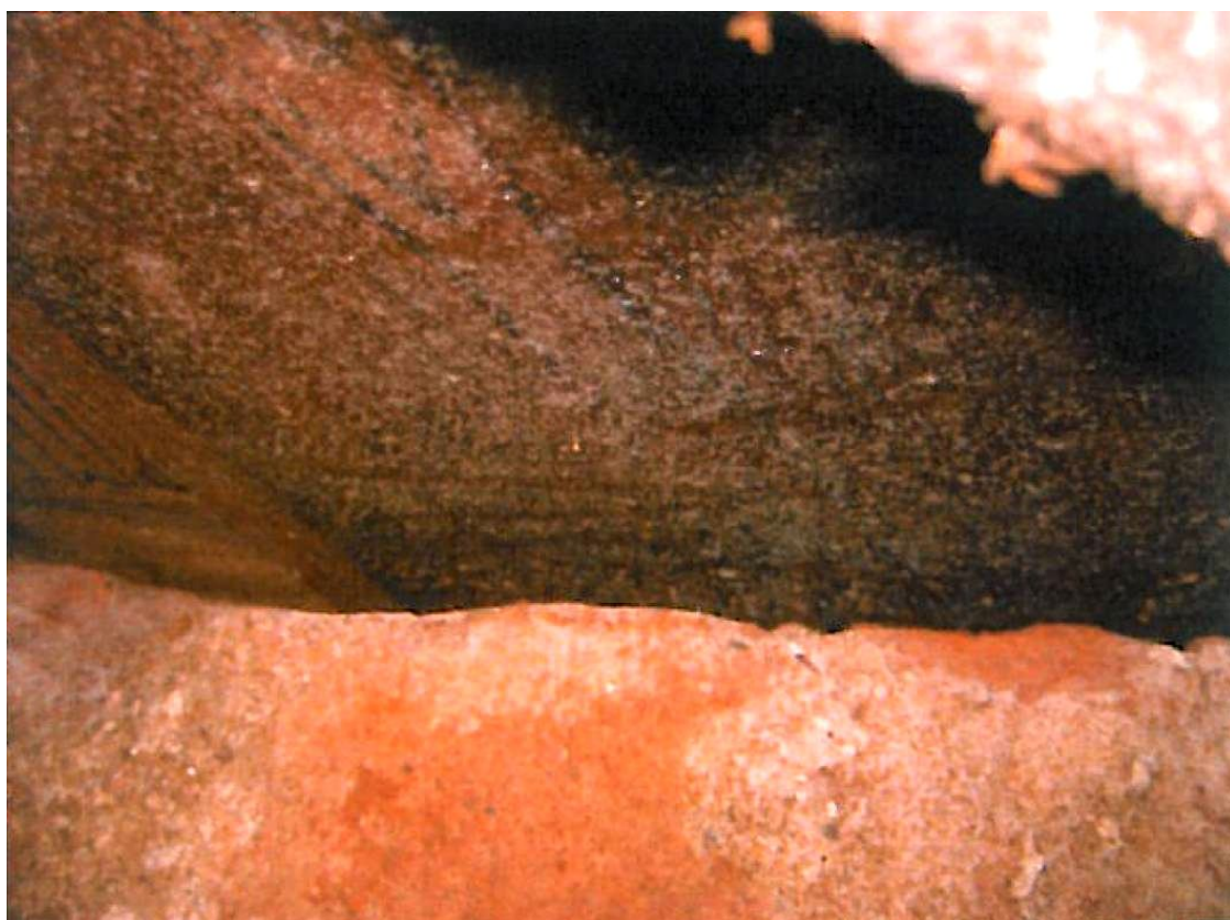
Obr. 43: Sonda 1 - zaplísněný povrch dřeva (Foto: J. Řehák)
