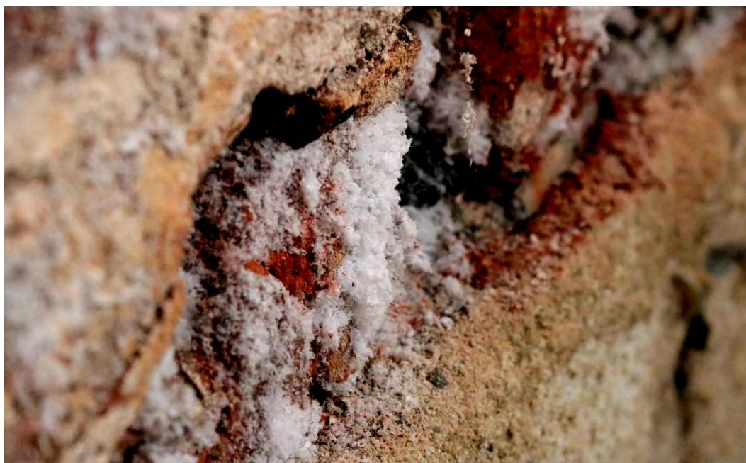
Obr. 36: Výkvěty solí na vnitřní straně zdi Nemocničního křídla kláštera (Foto: J.Řehák)
