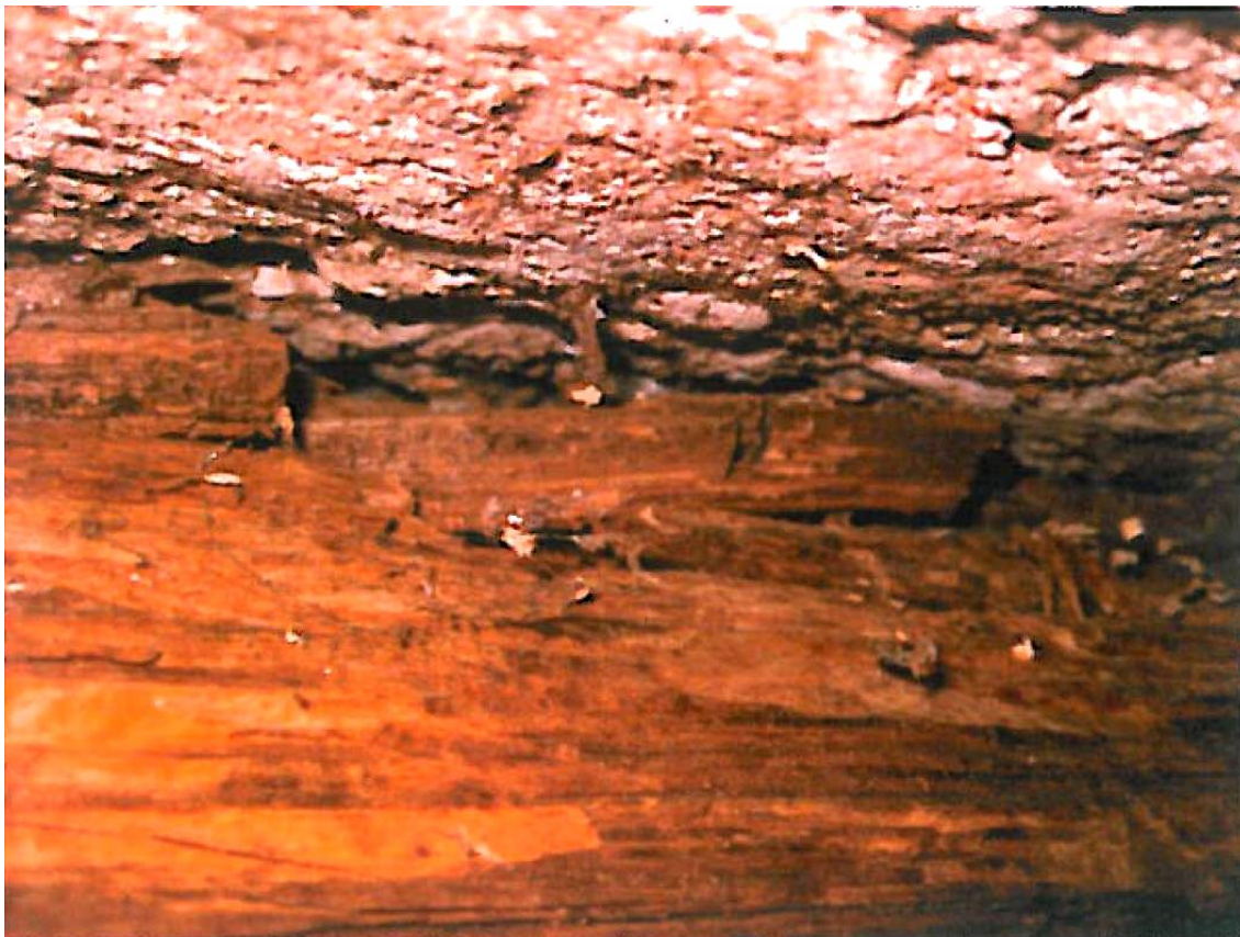
Obr. 45: Sonda 4 - Dřevokazná houba trámovka na konstrukci schodiště u zdi (Foto: J. Řehák)
