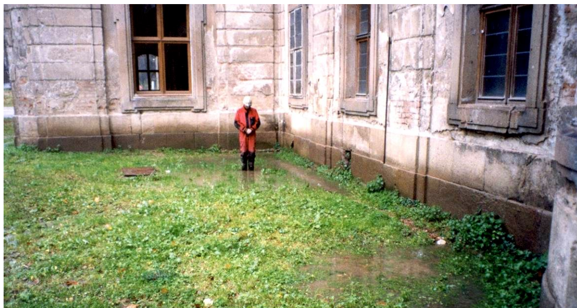
Obr. 22: Stojící voda po dešti u paty objektu před opravou podpvrchových kanálků (Foto: archiv SPELEO-Řehák)
