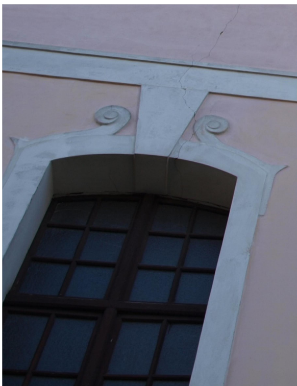
obr. 74 Trhlina v nadpraží okna interiéru [8]
