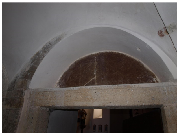
obr. 77 Trhlina v kamenném prahu vstupních dveří [8]
