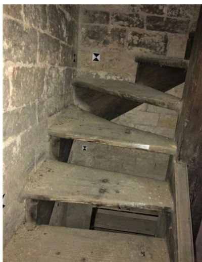
obr. 21 Mechanicky opotřebované schodnice
