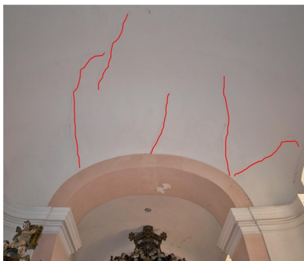
obr. 49 trhliny nad vítězným obloukem hlavní lodi [12]
