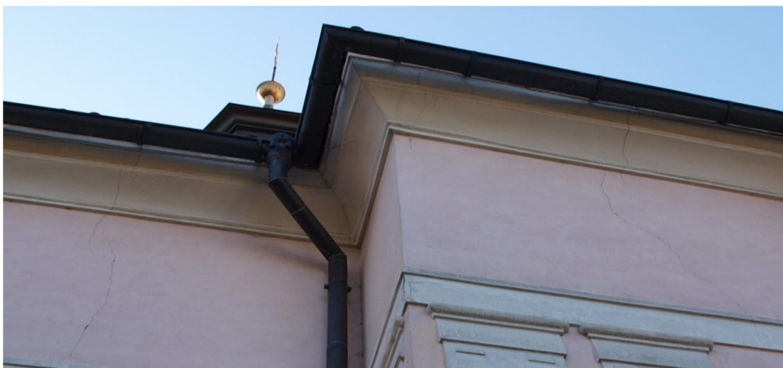
obr. 76 Trhlina prostupující římsou [8]
