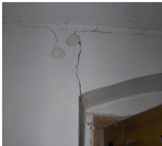
obr. 34 Začátek trhliny – východní strana presbytáře [12]
