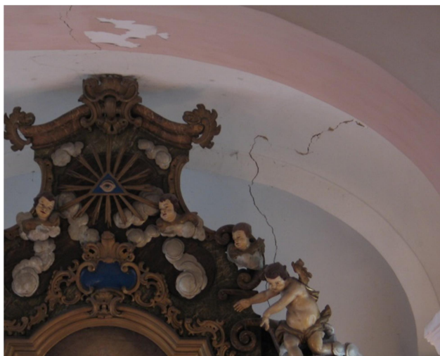
obr. 33 Trhlina ve vrcholu kleny - východní strana presbytáře [12]
