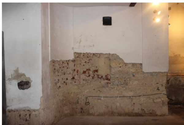
obr.13 Kvádry opuky jsou místy nahrazeny cihelným zdivem [12]
