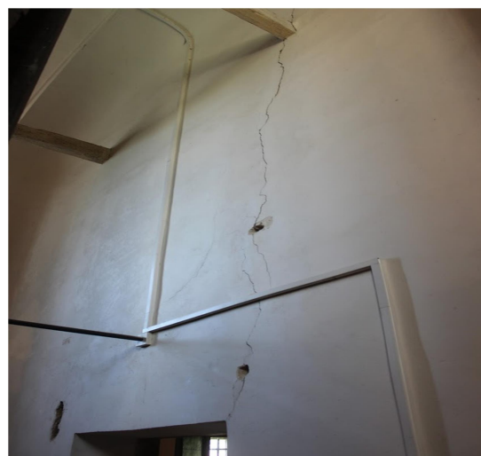
obr. 50 nejrozsáhlejší trhlinka - přechod presbytáře a sakristie [12]
