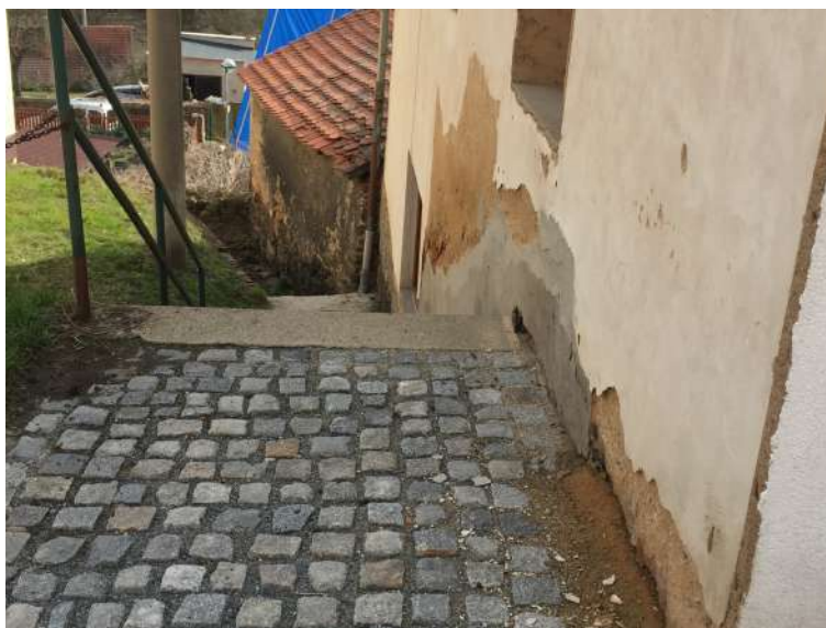
Obr. 7.2: Budova č. p. 267. Rozklad a opadávání vnější omítky v místech styku obvodové stěny a dlážděné cesty vlivem odstříkující a vzlínající vody.
