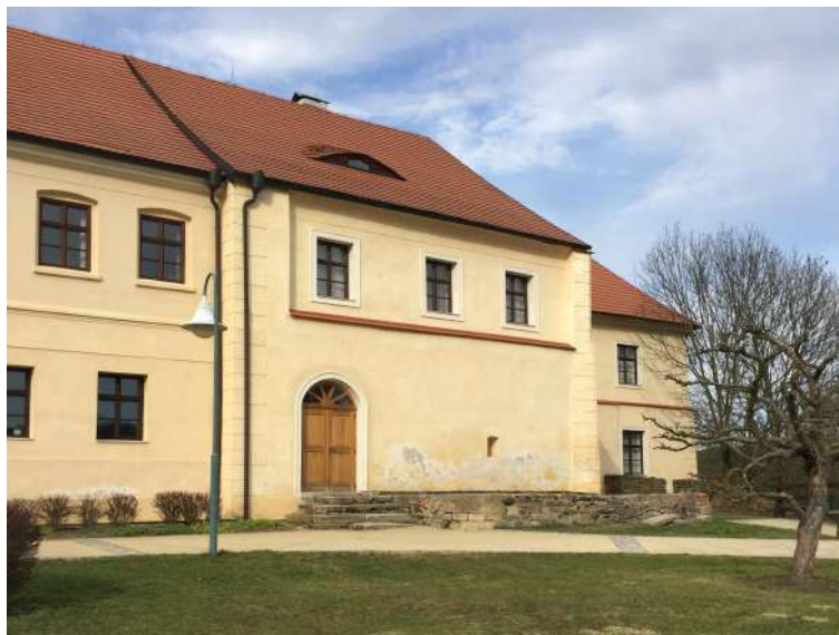
Obr. 7.8: Budova č. p. 20, městské muzeum. Neřešená vzlínající vlhkost při rekonstrukci objektu způsobuje odlupování nové omítky nad kamenným soklem budovy.
