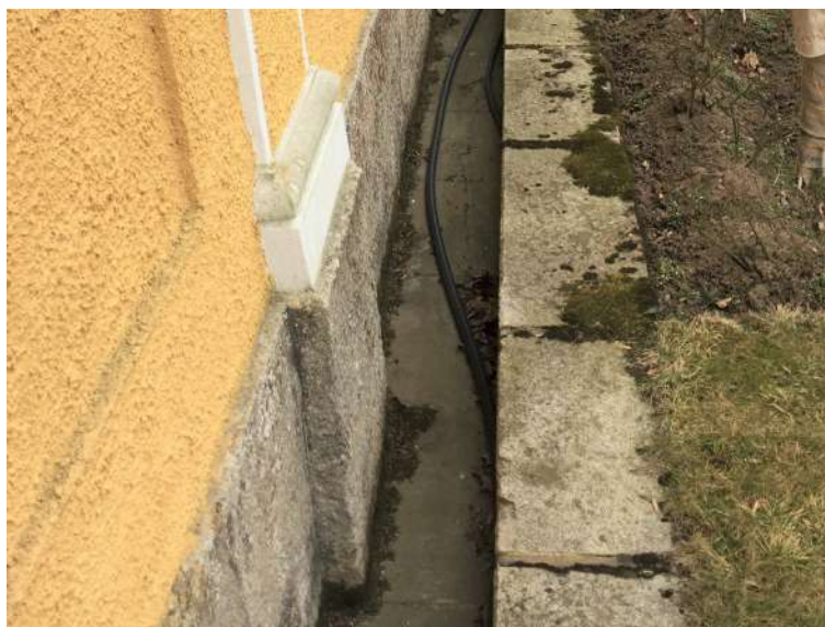
Obr. 5.11: zámek Kozel, odvětrávací příkop při patě vnějšího obvodového zdiva
