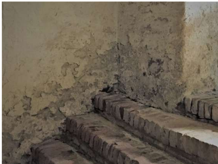
Obr. 5.8: hrad Švihov, omítka narušená vysokou vlhkostí ve sklepe pod jižním palácem
