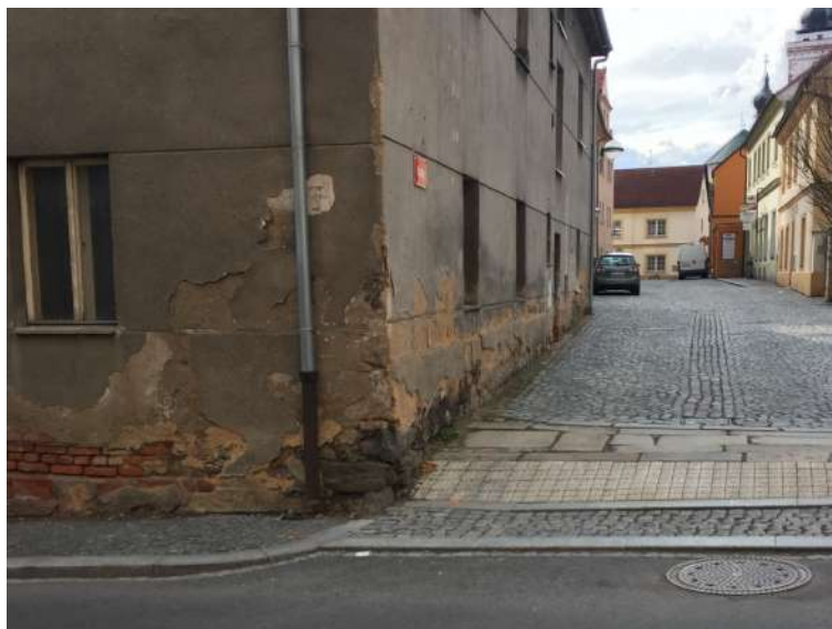
Obr. 7.6: Budova č. p. 53. Opadávání vnější omítky, degradace soklového zdiva, absence malty ve spárách způsobuje vzlínající vlhkost, odstříkující voda a zatékání od porušeného napojení okapového svodu do gajgru.
