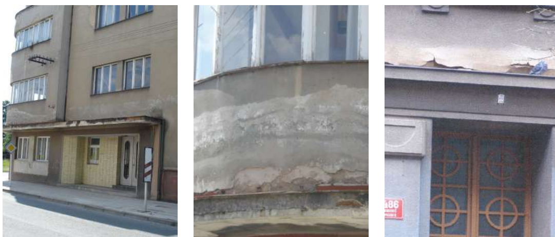
Obr. 3.2: degradace zdiva v důsledku odstříkující vody, převzato z [14]
