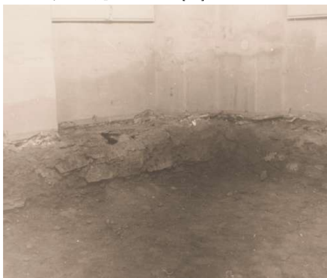
Obr. 5.18: zámek Kozel — rehabilitace odvětrávacího systému, stopy po vlhkosti, mokré zdivo u paty, převzato z [34]
