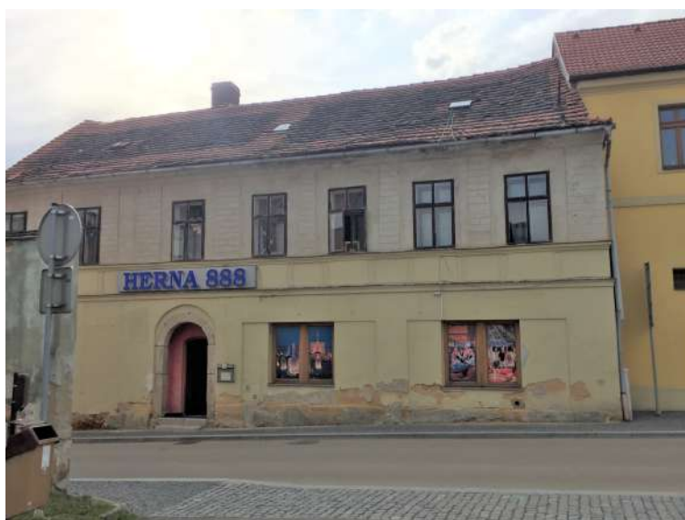
Obr. 7.7: Budova č. p. 55. Vzlínající vlhkost způsobuje destrukci a odpadávání vnější omítky na soklovém a nadsoklovém zdivu východní fasády.
