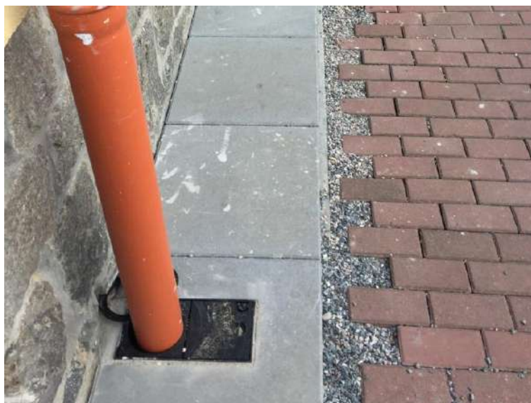
Obr. 3.8: Vzdušník zakrytý betonovými tvarovkami, odtahový kanál (falešný okap)
