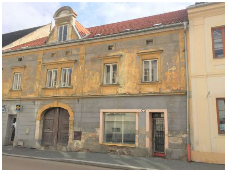
Obr. 7.4: Budova č. p. 93. Vlivem odstříkující vody nad oplechováním kordonové římsy dochází k odlupování omítky. Degradace soklového zdiva, absence malty ve spárách a výkvěty solí je způsobeno vzlínající a odstříkující vodou.
