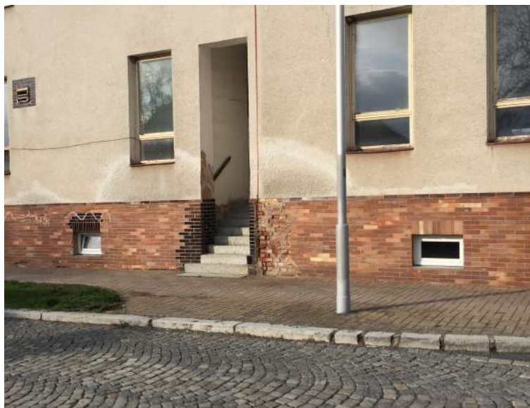
Obr. 7.1: Budova č. p. 719. Vzlínající vlhkost způsobuje destrukci kabřincového obkladu, tvorbu solných výkvětů, vlhkostních map a opadávání omítky nad kabřincovým obkladem. Mapy a výkvěty dosahují díky nepropustnému obkladu až do výšky 2 m nad terén.
