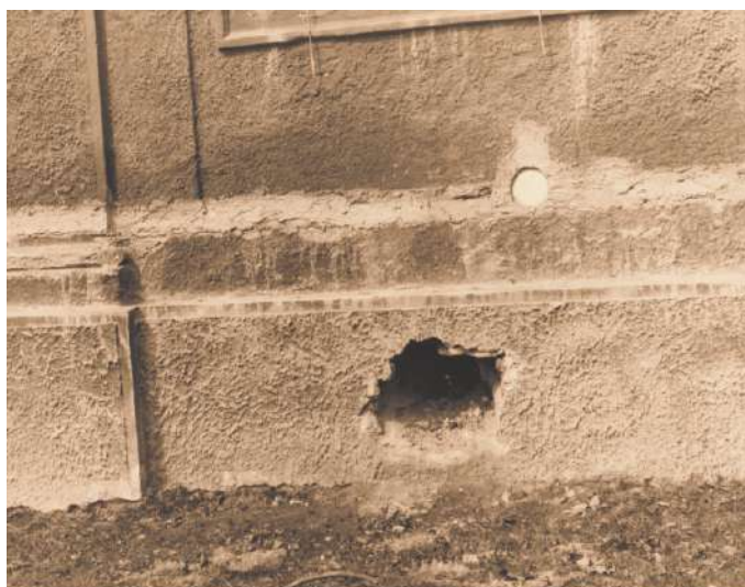
Obr. 5.14: zámek Kozel — rehabilitace odvětrávacího systému, nasávací otvor, převzato z [34]
