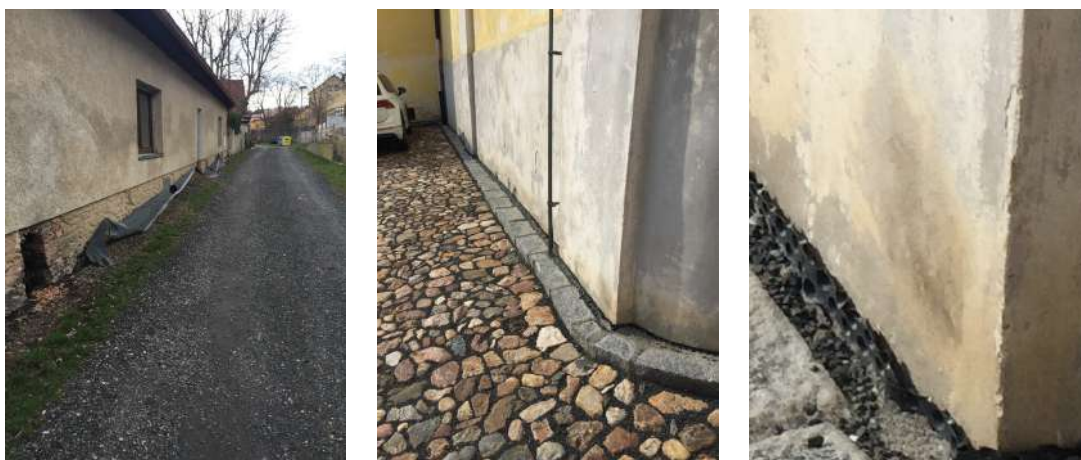
Obr. 3.3: nopová fólie není ukončena, stékající voda se vsakuje do zdiva
