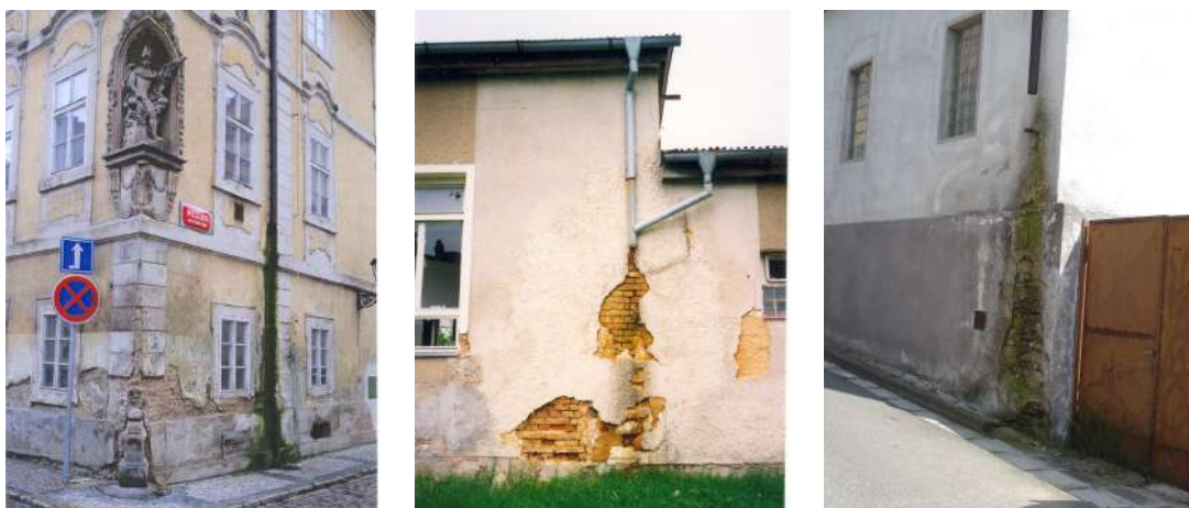
Obr. 3.1: degradace omítky v důsledku chybějící části svodu, převzato z [14]
