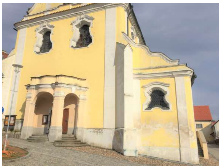
Obr. 7.5: Kostel Všech Svatých. Odlupování relativně nové vnější omítky ve spodních částech objektu je způsobeno vzlínající vlhkostí. Poruchy jsou doprovázeny výskytem řas Chlorella v místech odstříkující vody nad oplechováním říms.
