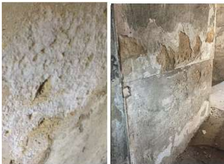
Obr. 6.5: klášter Chotěšov, výkvěty solí na povrchu zdiva
