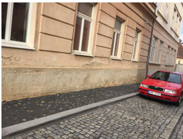
Obr. 7.9: Budova č. p. 17. Odlupování nové vnější omítky na soklovém zdivu je způsobeno vzlínající vlhkostí a zejména odstříkující vodou.
