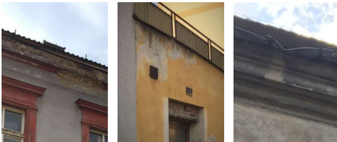
Obr. 3.4: destrukce římsy vlivem chybějícího nebo poničeného okapního žlabu, špatné oplechování
