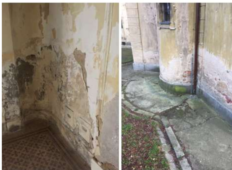
Obr. 6.4: klášter Chotěšov, opadaná vnitřní a vnější omítka vlivem vzlínající vlhkosti
