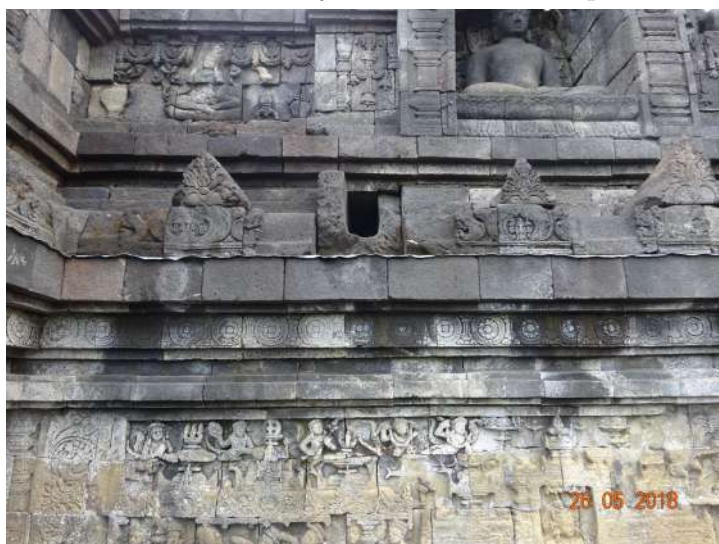
Obr. 2.7: Borobudur, dodatečně vložená hydroizolace, převzato z [14]
