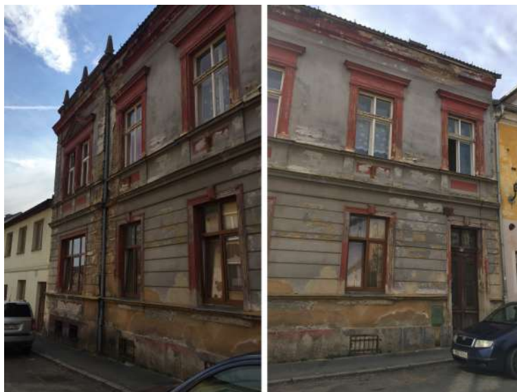
Obr. 7.3: Budova č. p. 528. Vlivem odstříkující vody dochází k odlupování omítky nad kordonovou římsou. Destrukce zdiva v místě okapu a podokapového žlabu způsobuje zatékání. Vlhkostní mapy a výkvěty solí ve výšce 1,5 m na soklovém a nadsoklovém zdivu jsou způsobeny vzlínající vlhkostí.
