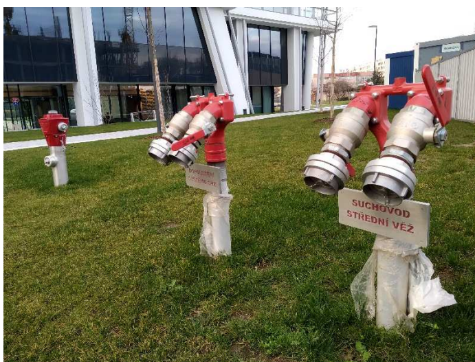
Obrázek č. 11: Napojení na požární potrubí před výškovou budovou V Tower [vlastní foto]
