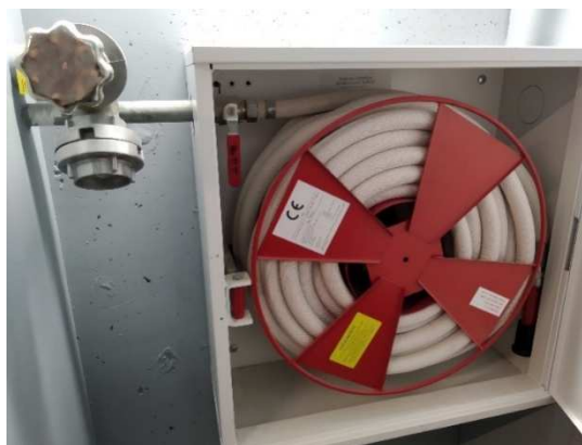
Obrázek č. 10: Požární potrubí a nástěnný hydrant [vlastní foto]
