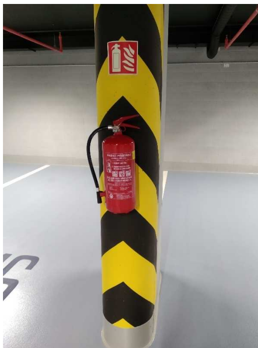
Obrázek č. 13: Umístění PHP na sloupu v hromadné garáži [vlastní foto]
