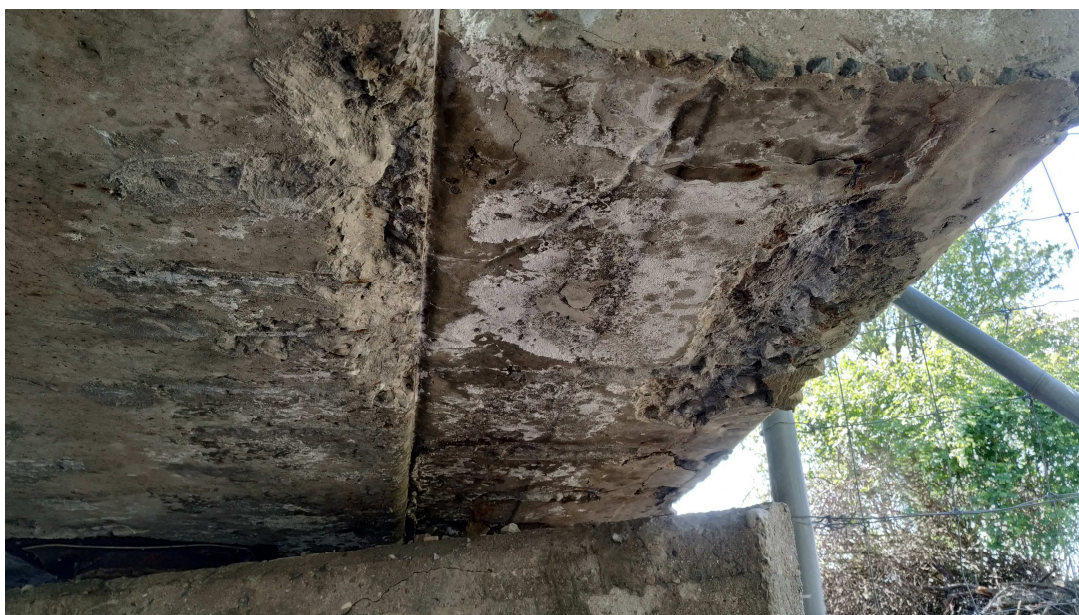
Obrázek 3 - Degradovaný spodní povrch nosníku
