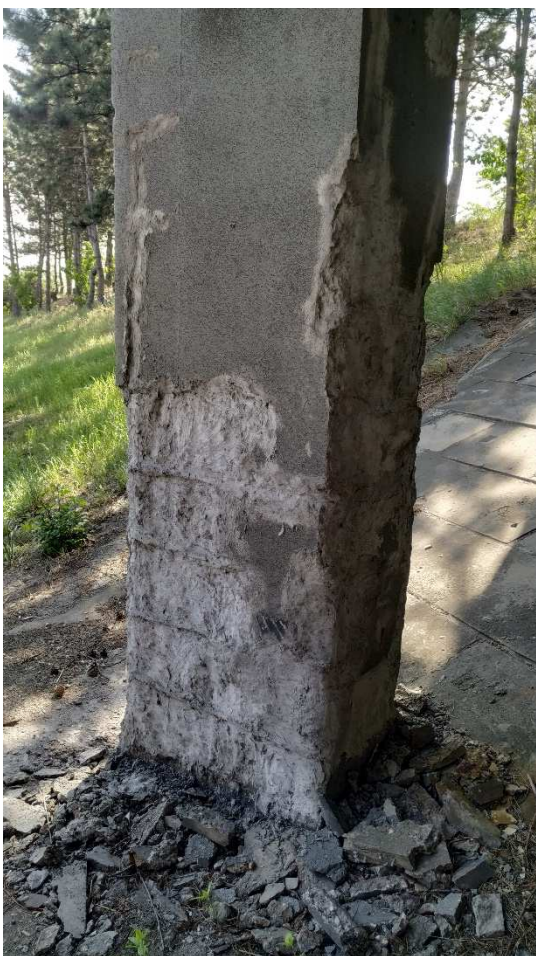
Obrázek 5 - Degradovaný pilíř mostu
