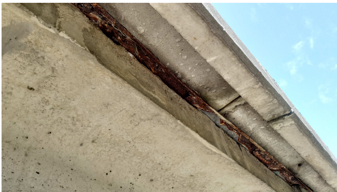
Obrázek 4 - Zkorodovaná okapnička pod římsou
