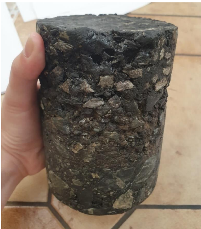
Obrázek 18 – Jádrový vývrt s viditelným vypoceným asfaltem [13]
