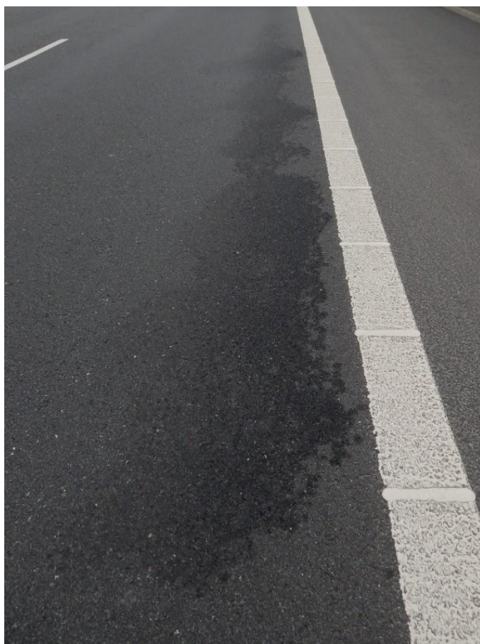
Obrázek 19 – „Vypocený“ asfalt na dálnici D3 [13]
