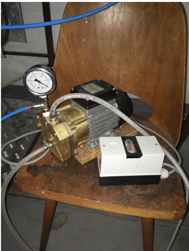
Obr. 27: Vodokružná vývěva pro vakuové sušení
