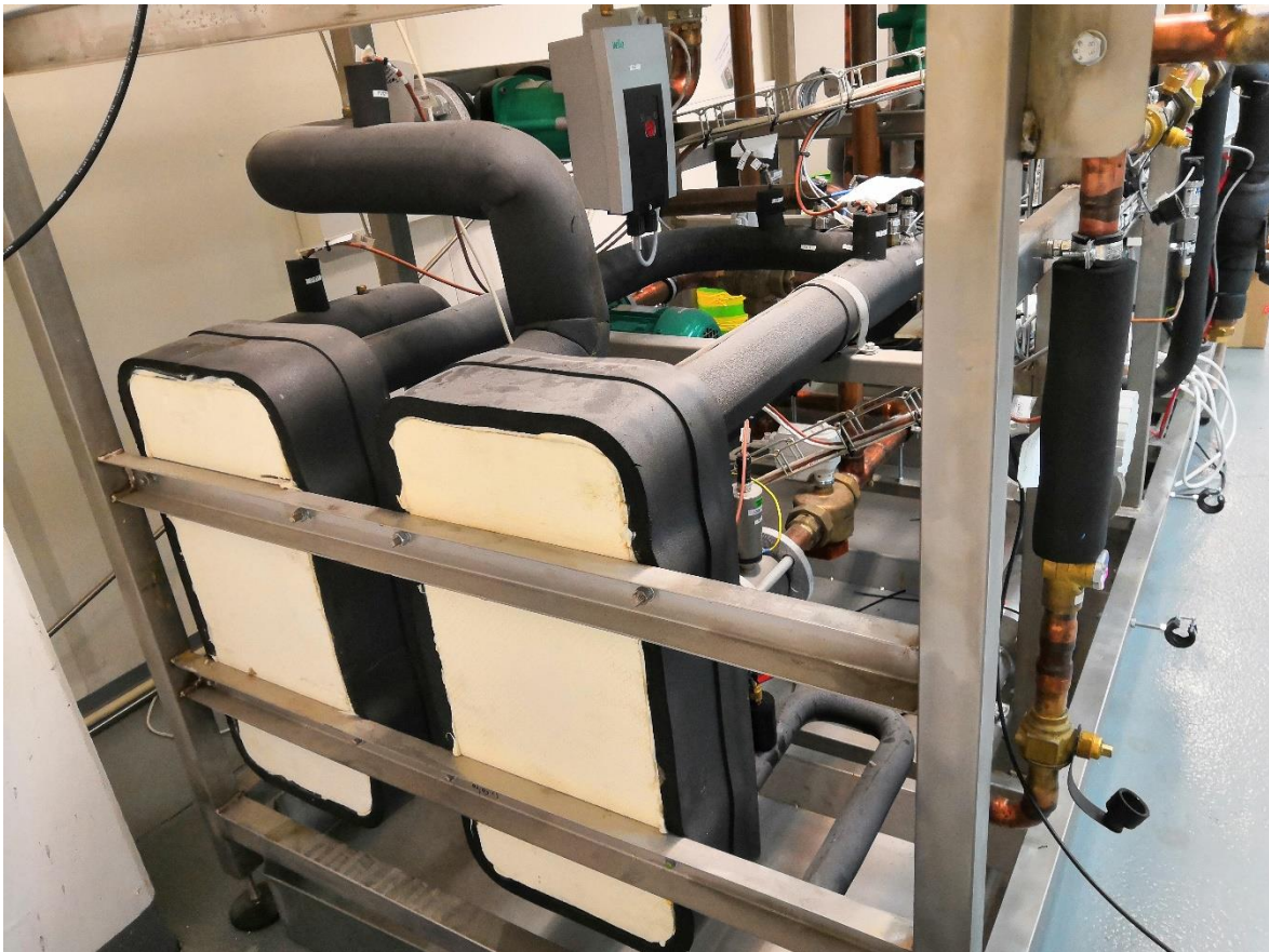
Obr. 15: Vodou chlazený výparník oběhu CL80 ve zkušebním okruhu
