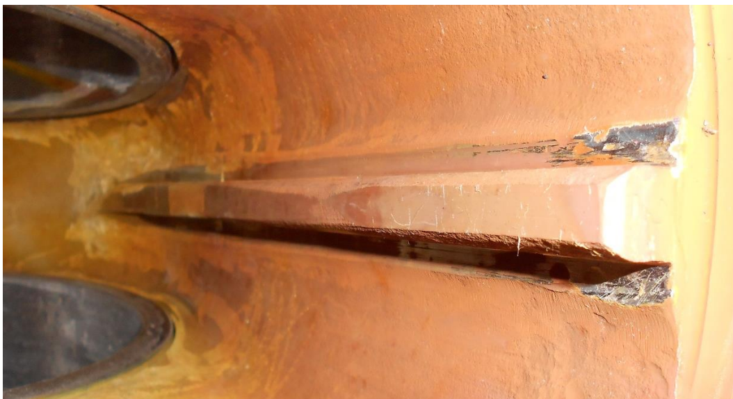
Obrázek 26: Úbytek materiálu na armatuře 1TQ21S02 (zdroj: Archiv ETE)
