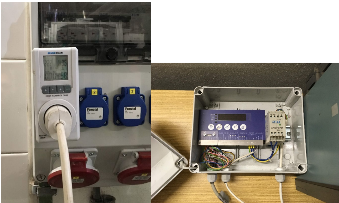
Obrázek 5-7: Elektroměr pro odečet spotřeby Obrázek 5-6: Měřicí stanice pro odečet hmotnosti energie
