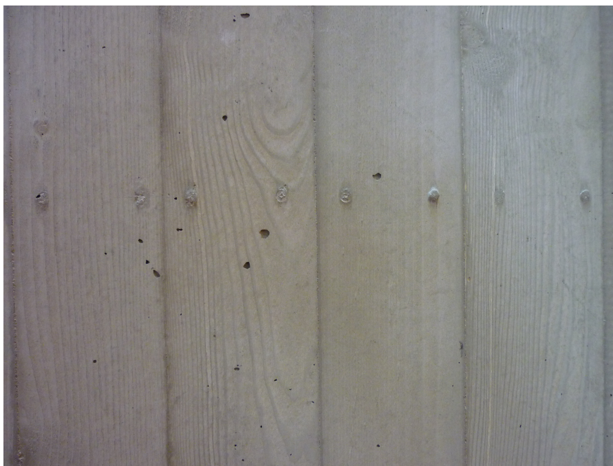
Obrázek 3.5: Fotografie betonu z hlavního schodiště
