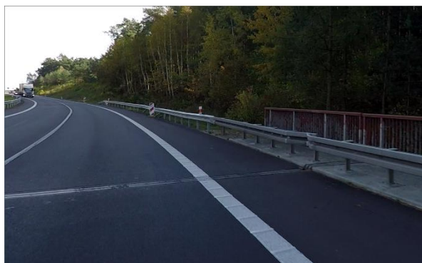
Obrázek 20 – Přerušené boční svodidlo – staničení km 23,592 (ID 9530)
