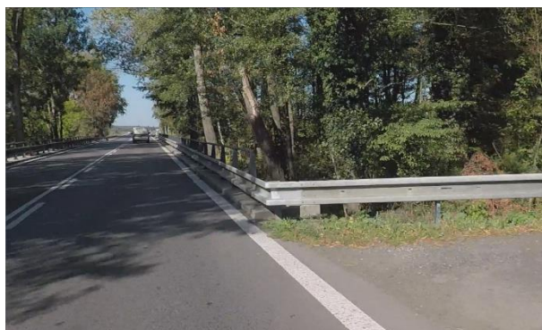
Obrázek 49 – Neadekvátně provedené svodidlo – staničení km 9,207 (ID 304)
