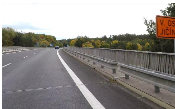
Obrázek 22 – Přerušené boční svodidlo – staničení km 70,689 (ID 10045)
