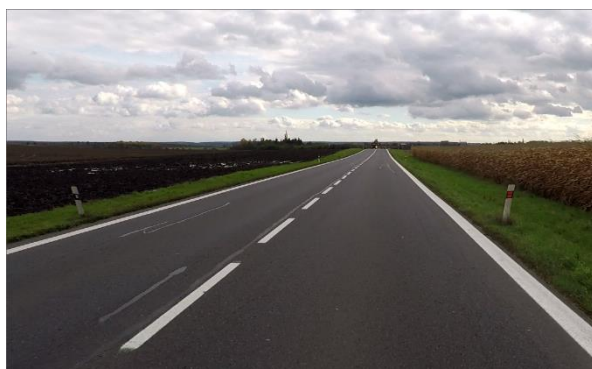
Obrázek 53 – Nedostatečné rozhledové poměry – staničení km 40,264 (ID 9769)
