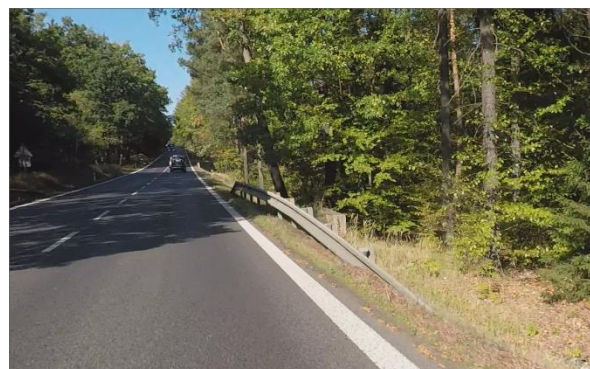
Obrázek 43 – Krátké svodidlo u příčného propustku – staničení km 2,950 (ID 386)
