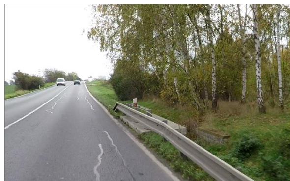
Obrázek 41 – Krátké svodidlo u příčného propustku – staničení km 92,149 (ID 11122)
