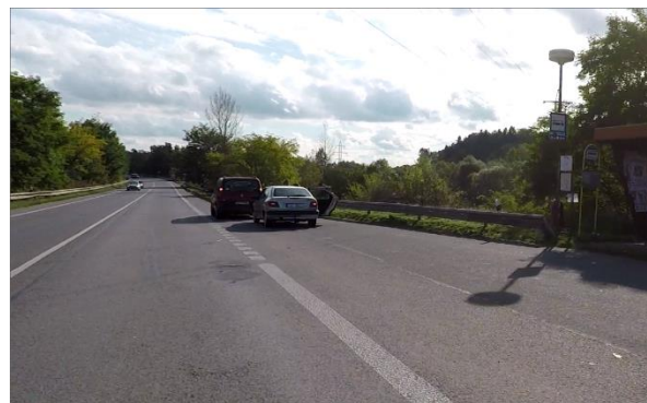
Obrázek 45 – Krátký výškový náběh svodidla – staničení km 30,842 (ID 9570)
