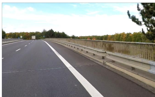
Obrázek 23 – Přerušené boční svodidlo – staničení km 70,793 (ID 10248)
