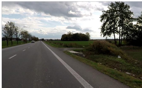
Obrázek 32 – Tuhé čelo příčného propustku – staničení km 66,804 (ID 10012)
