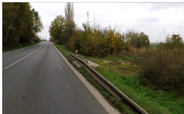
Obrázek 19 – Absence výškového náběhu svodidla – staničení km 92,160 (ID 12493)
