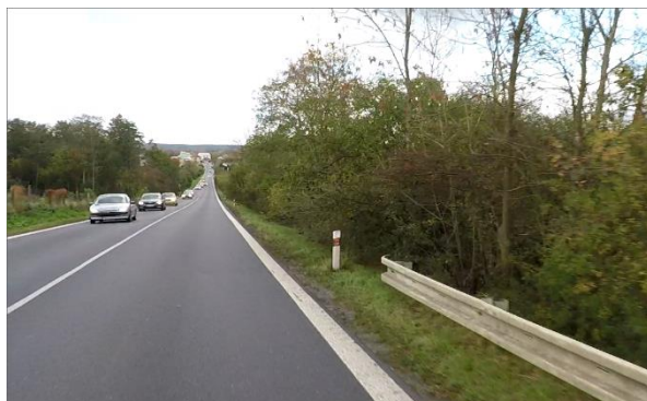
Obrázek 18 – Absence výškového náběhu svodidla – staničení km 49,128 (ID 10564)
