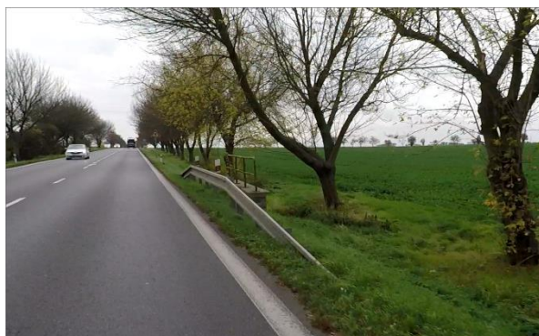
Obrázek 42 – Krátké svodidlo u příčného propustku – staničení km 111,515 (ID 11684)
