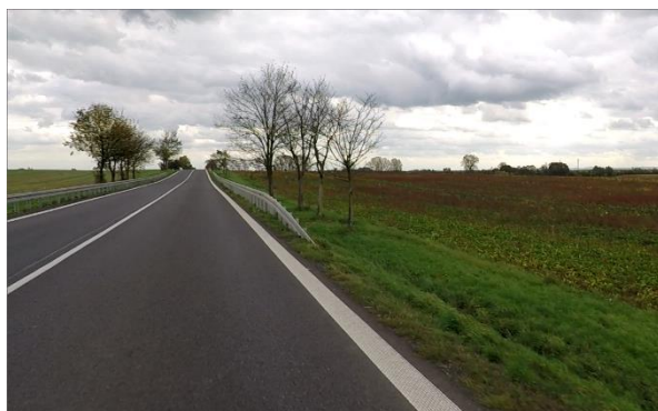
Obrázek 33 – Krátké svodidlo před stromem – staničení km 52,260 (ID 9921)
