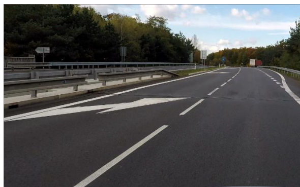
Obrázek 21 – Přerušené boční svodidlo – staničení km 70,693 (ID 10251)
