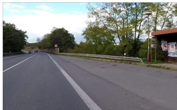
Obrázek 47 – Krátký výškový náběh svodidla – staničení km 30,783 (ID 9626)
