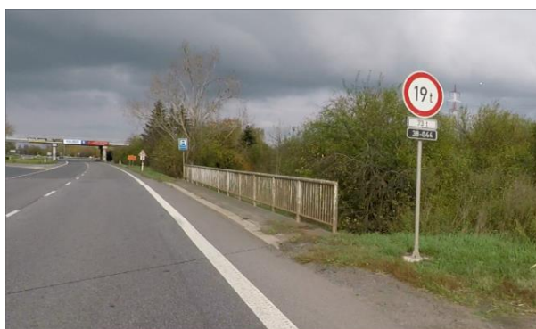
Obrázek 35 – Nevhodný typ zádržného zařízení – staničení km 95,151 (ID 12411)
