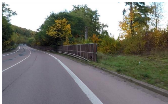
Obrázek 29 – Krátké svodidlo před čelem PHS – staničení km 29,883 (ID 9634)
