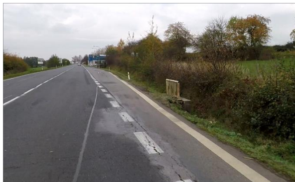
Obrázek 31 – Tuhé čelo příčného propustku – staničení km 114,335 (ID 11901)
