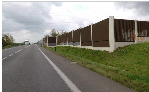
Obrázek 30 – Absence svodidla před čelem PHS – staničení km 86,877 (ID 12541)
