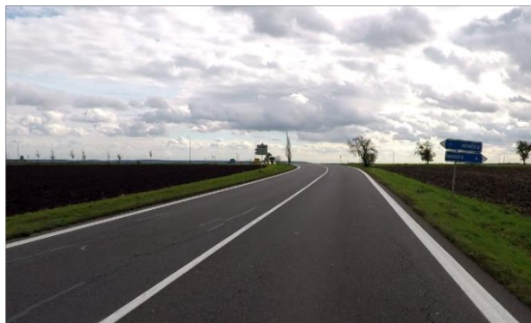
Obrázek 60 – Náhlá změna směrového a výškového vedení komunikace – staničení km 38,764 (ID 9757)
