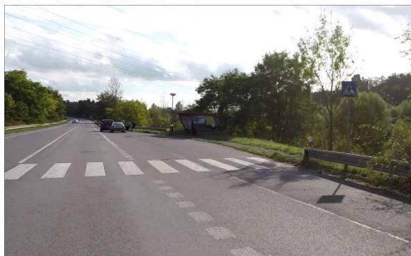
Obrázek 44 – Krátký výškový náběh svodidla – staničení km 30,807 (ID 9565)
