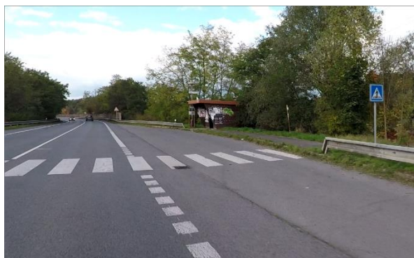
Obrázek 46 – Krátký výškový náběh svodidla – staničení km 30,812 (ID 9625)
