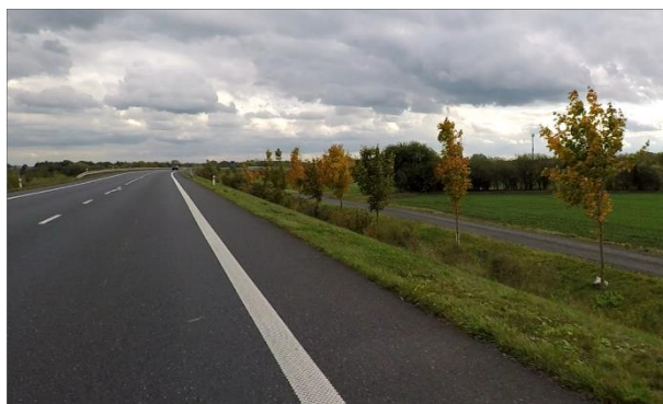
Obrázek 59 – Absence zádržného zařízení v místě, kde je vysoký násep – staničení km 60,565 (ID 10209)
