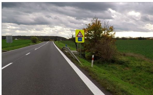
Obrázek 40 – Krátké svodidlo u příčného propustku – staničení km 47,182 (ID 9848)
