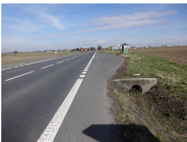
Obrázek 6 – Bližší pohled na bezpečnostní deficit (tuhé čelo propustku) nacházející se na jižním rameni křižovatky pod BUS zastávkou.
