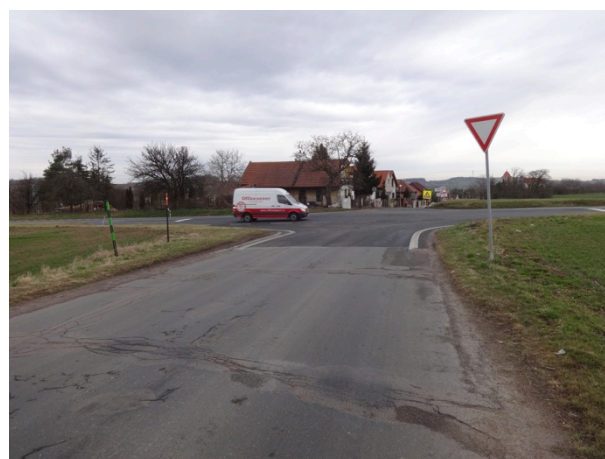
Obrázek 5 – Pohled na sledovanou lokalitu z jižního ramene křižovatky (silnice III/334 4). Ukázka neadekvátního techn. stavu krytu vozovky.
