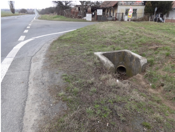
Obrázek 6 – Bližší pohled na bezpečnostní deficit (betonový propustek) nacházející se mezi severním a východním ramenem křižovatky.
