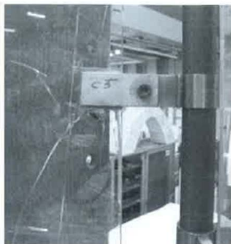
Obr. 3.20: Pohled na lokální porušení skleněného panelu
