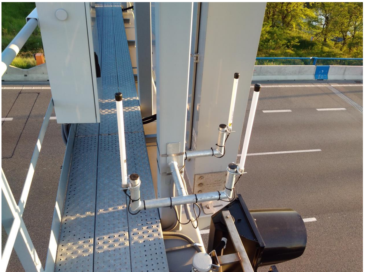
Obr. 10: Anténní pole RSU instalované na dopravním portálu nad dálniční komunikací [11]
