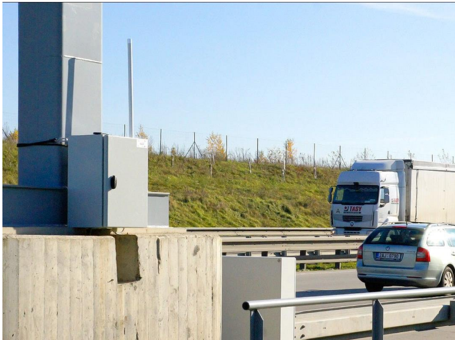
Obr. 8: Vybavení dopravní infrastruktury jednotkou RSU pro komunikaci ETSI ITS G5 [10]
