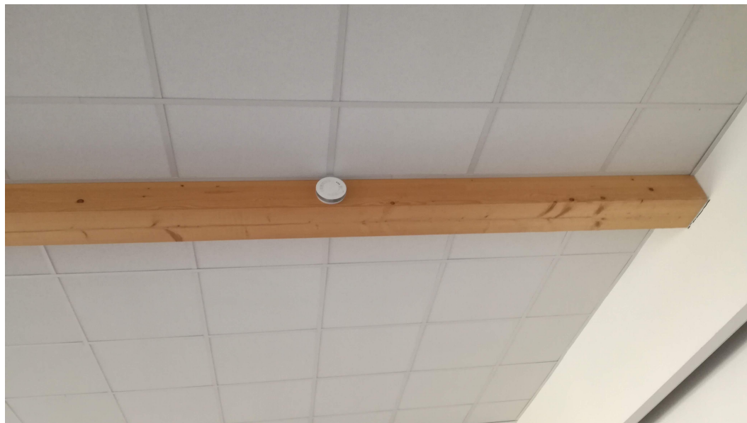
Obrázek 24 Umístění kouřového detektoru – obytná místnost (nad kuchyňským koutem) (vlastní fotografie)
