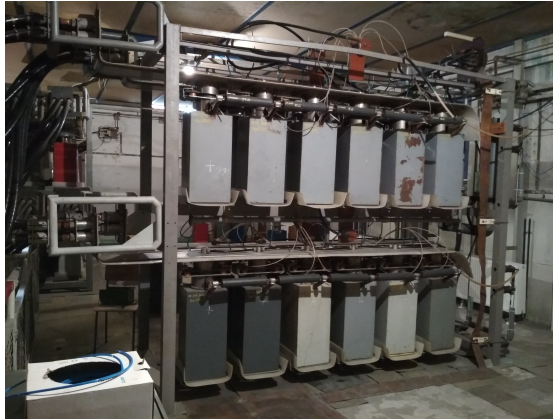
Obrázek 2.5: Kondenzátorová baterie generátoru PF-1000 v Institutu Fyziky Plasmy i Laserowej Mikrosintezy ve Varšavě. Energie baterií je 1 MJ, maximální napětí dosahuje 40 kV [Fotoarchiv autora].
